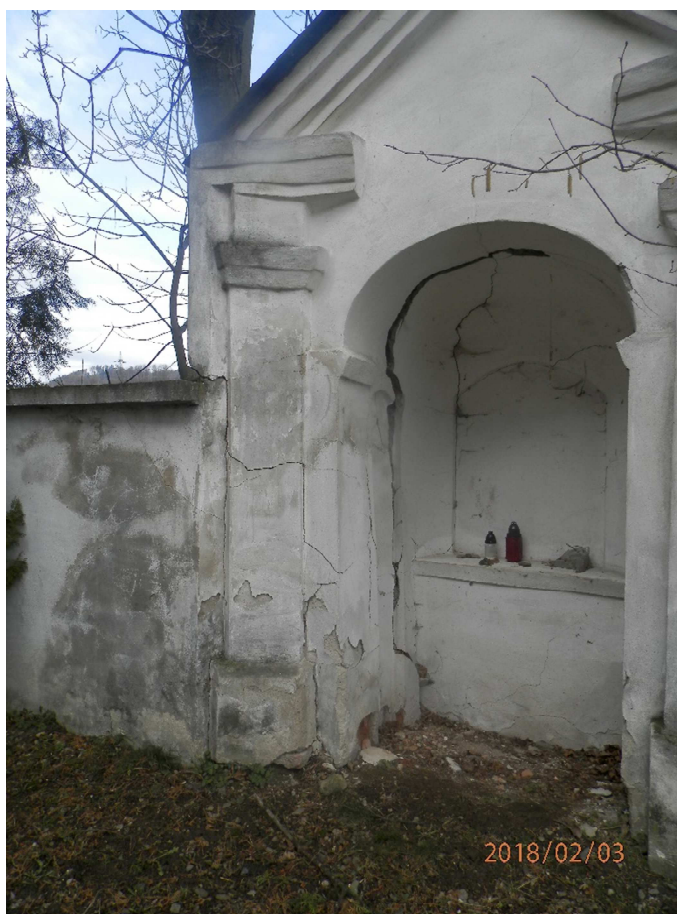
Obr. č. 23 – Detail poruchy zdiva kapličky 8
