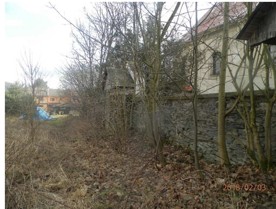
Obr. č. 28 – Pohled na rub ohradní zdi (v místě navržených odstranění křovin)
