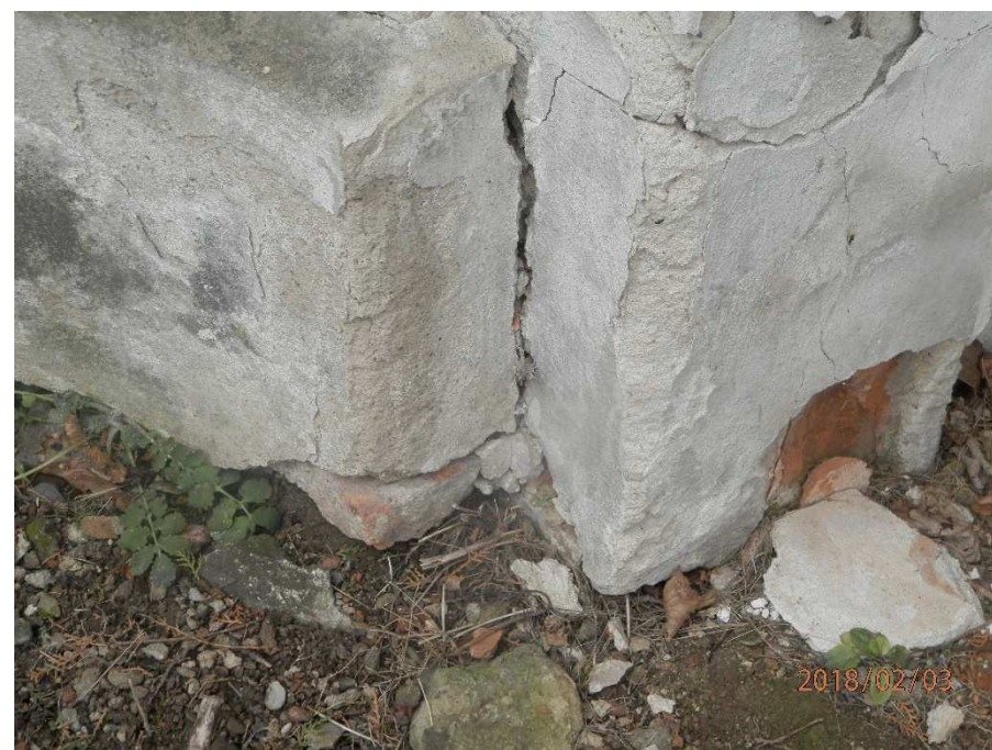
Obr. č. 26 – Detail poruchy zdiva kapličky 8
