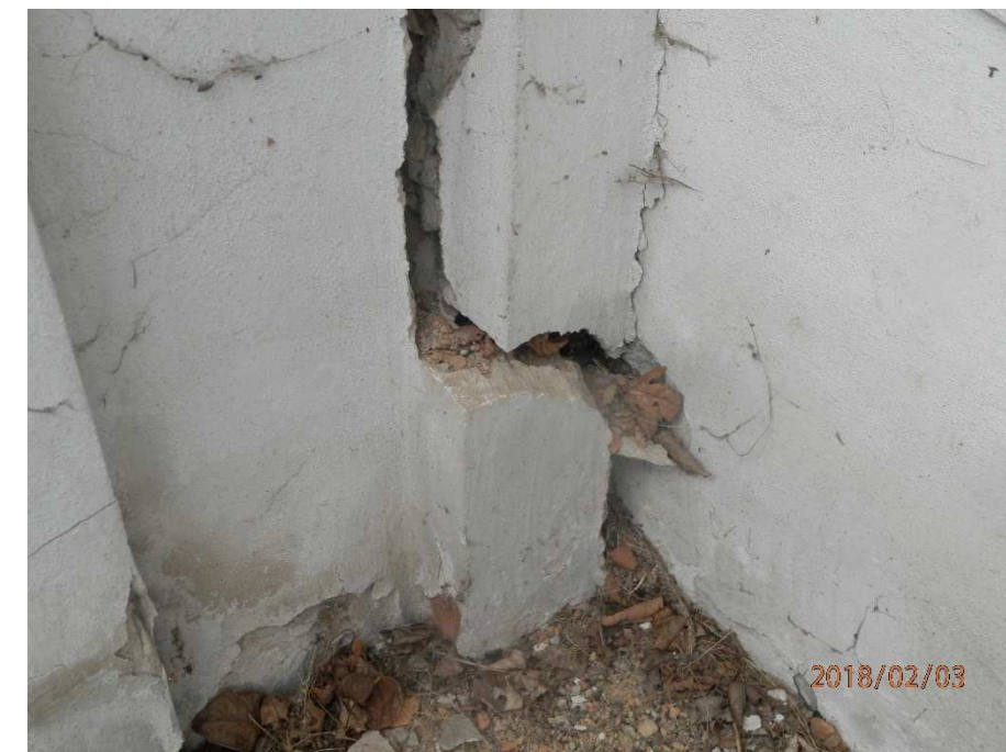
Obr. č. 25 – Detail poruchy zdiva kapličky 8
