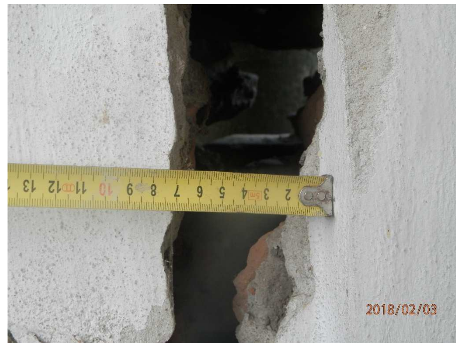
Obr. č. 24 – Detail poruchy zdiva kapličky 8
