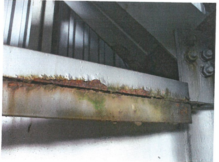
8. SO 4220 Těžní věž jámy č.4 – vodorovné ztužení stěny – detail působení koroze na složený profil
