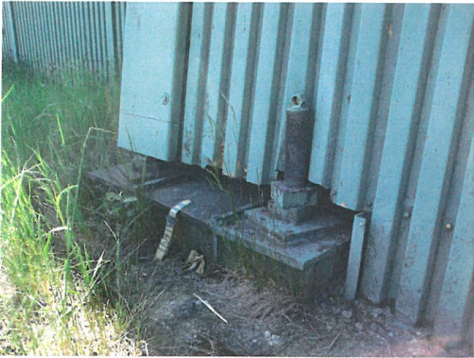
2. S SO 4220 Těžní věž jámy č.4 - pohled na kotvení sloupů severní stěny -levá
