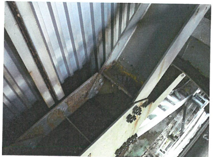
12. SO 4220 Těžní věž jámy č.4 – detail rámového styčnicku - vliv koroze
