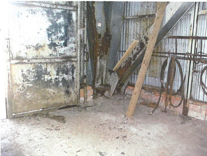
3. SO 4220 Těžní věž jámy č.4 - pohled na patku jižní stěna vedle vrat
