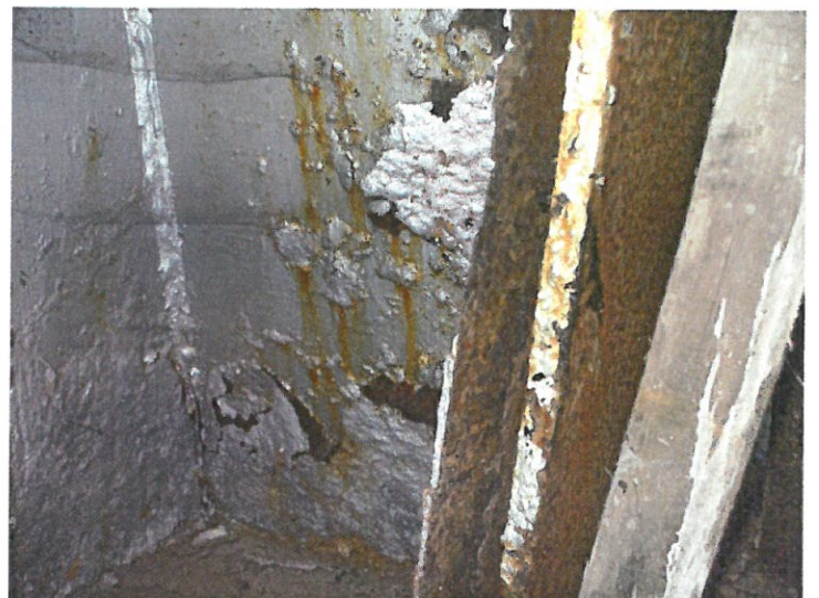
4. SO 4220 Těžní věž jámy č.4 - pohled na ocelovou patku jižní stěna vedle vrat – detail hloubkové koroze
