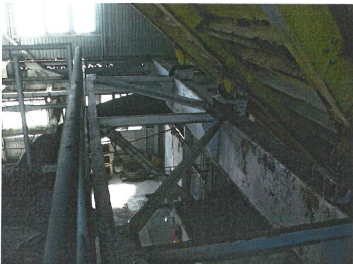
5. SO 4220 Těžní věž jámy č.4 –uložení sýpy – soodní nosník s vodorovným ztužidlem
