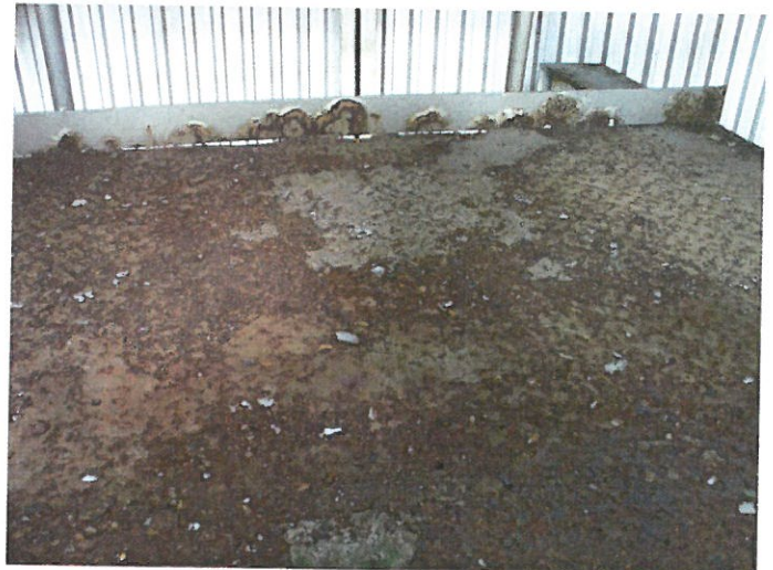
10 SO 4220 Těžní věž jámy č.4 - pohled na lávku ochozu – detail hloubkové koroze pochozích plechů
