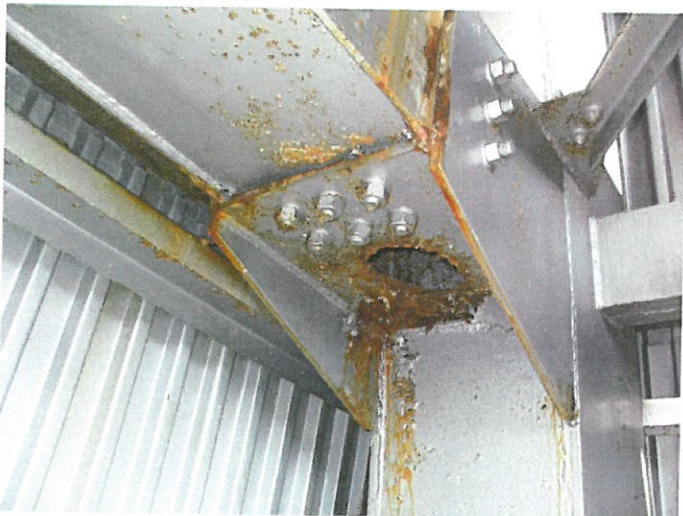
11. SO 4220 Těžní věž jámy č.4 - detail rámového styčnicku - vliv koroze
