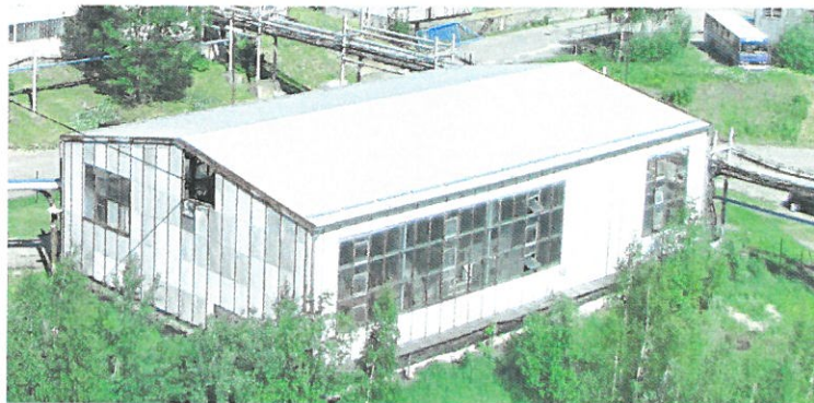
2. SO 5200 Strojovna těžního stroje 2C-6x2,4 – narušený obvodový plášť ve štítě
