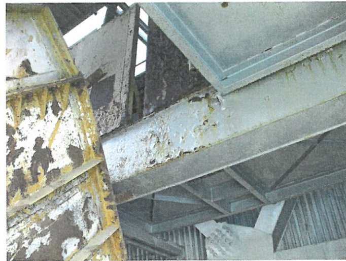
12. SO 5220 Těžní věž jámy č.5 – detail vlivu koroze pod nátěrem vnitřního nosníku plošiny věže
