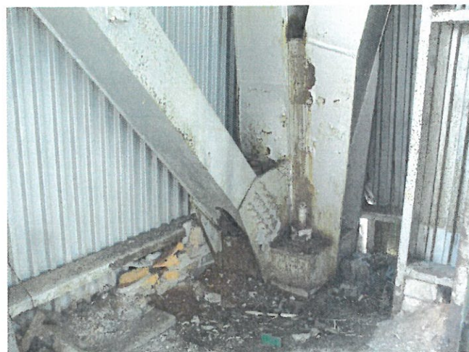
11. SO 5220 Těžní věž jámy č.5 - detail rámového styčnicku v patce OK věže - vliv koroze a destrukce zdivky soklu
