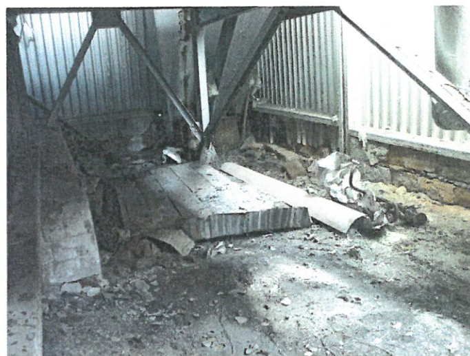
10. SO 5220 Těžní věž jámy č.5 – OK patka rámu věže – vliv koroze a celkové poškození zdiva soklu po obvodu věže
