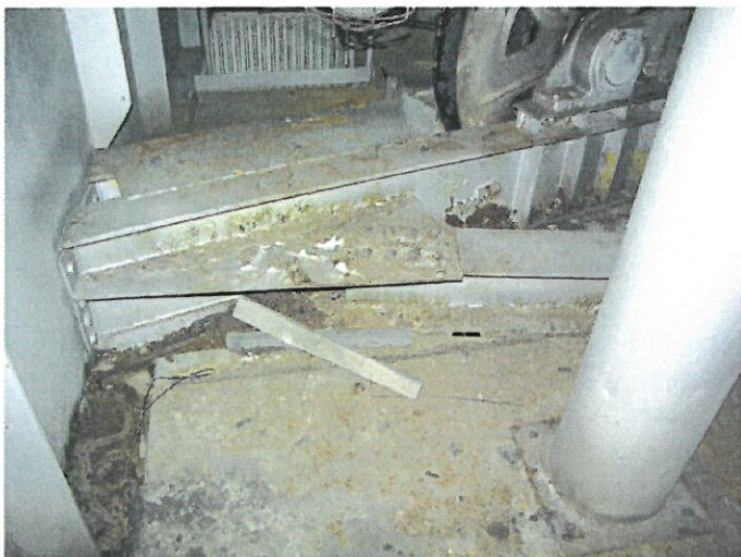
3. SO 5220 Těžní věž jámy č.5 – lanovnicový rošt – detail – vliv koroze
