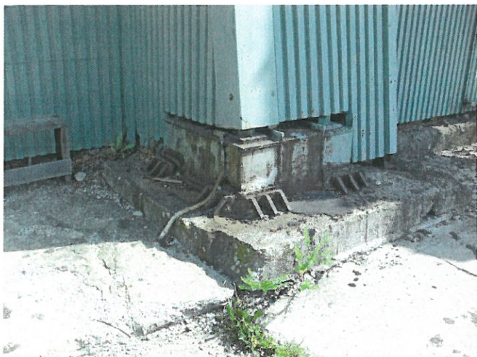
1. S SO 5220 Těžní věž jámy č.5 - pohled na kotvení sloupů jižní stěny - levá
