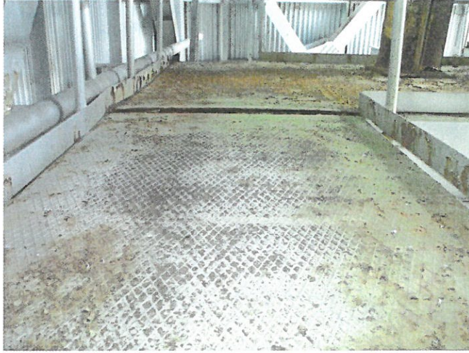
6. SO 5220 Těžní věž jámy č.5 – poškozené pochozí plechy lávek a ochozů
