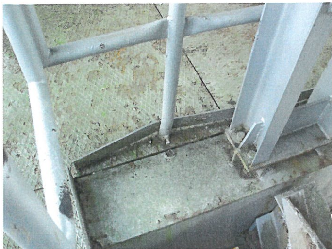
7. SO 5220 Těžní věž jámy č.5 – detail poškozeného sloupku zábradlí
