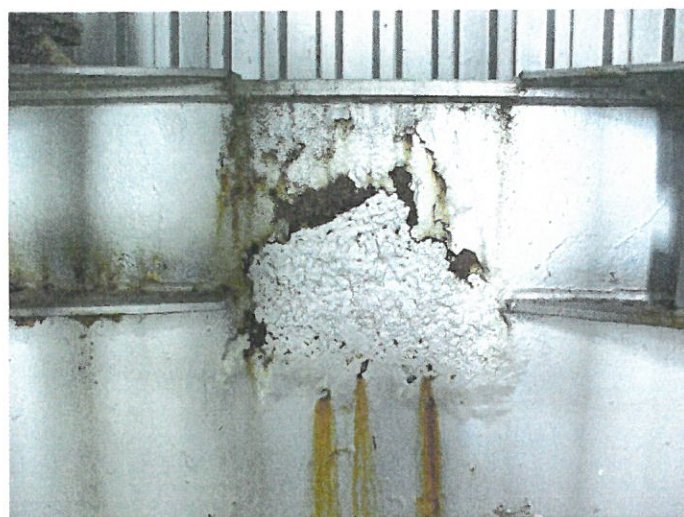
9. SO 5220 Těžní věž jámy č.5 – vliv hloubkové koroze ve styčnících příčle rámu stěny OK věže - detail
