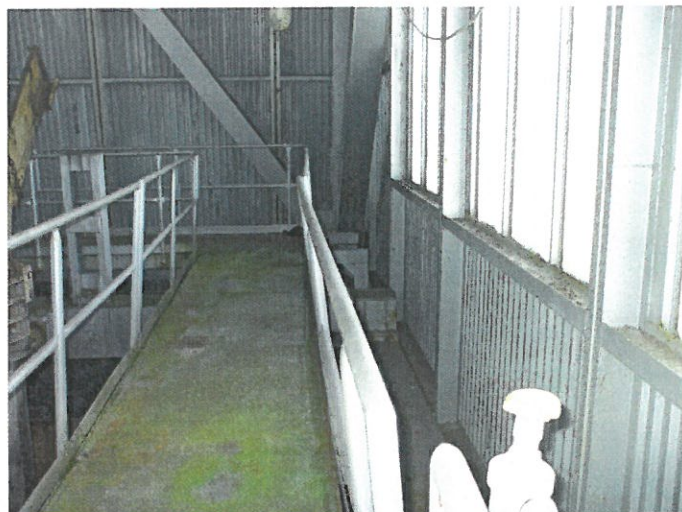
8. SO 5220 Těžní věž jámy č.5 – deformace zábradlí
