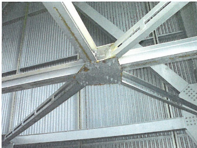
4. SO 5220 Těžní věž jámy č.5 - pohled na ocelovou konstrukci horizontálních ztužidel věže – detail vlivu koroze
