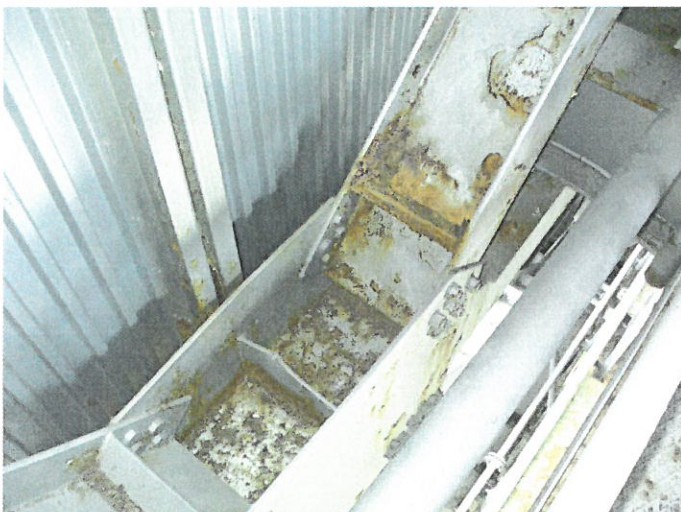
5. SO 5220 Těžní věž jámy č.5 – detail stykáčku rámu stěny OK věže – vliv koroze
