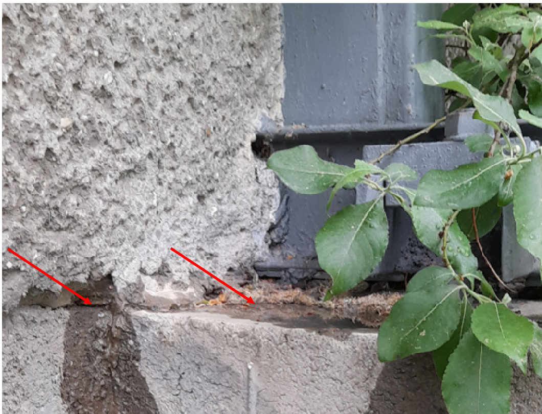
Obr. 20 Pronikání spodní vody pod úroveň hydroizolační vrstvy pod ŽB deskou podlahy
