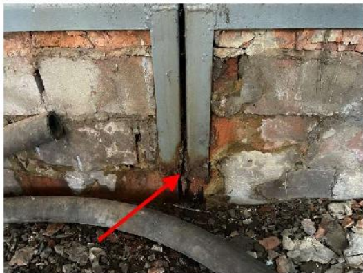
Vada č. 1 – častá vada – koroze svislých pažďíků opláštění
