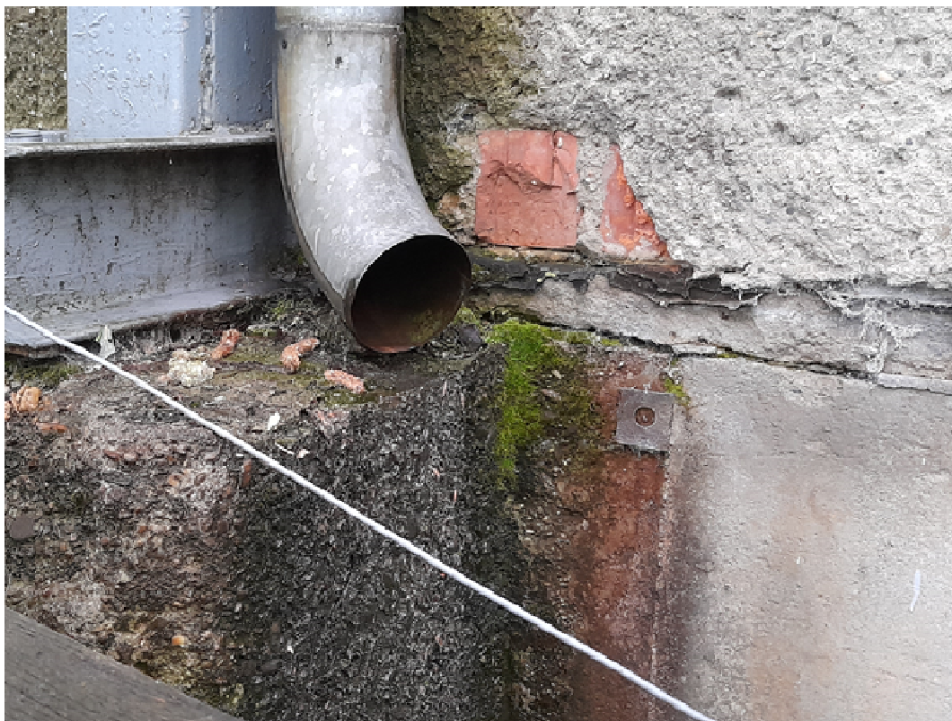
Obr. 22 Smáčení základové konstrukce dešťovou vedou ze svodu, biotické napadení betonu
