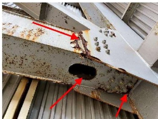
Vada č. 5 – častá vada – koroze styčnickových plechů a hlavních nosných konstrukcí
