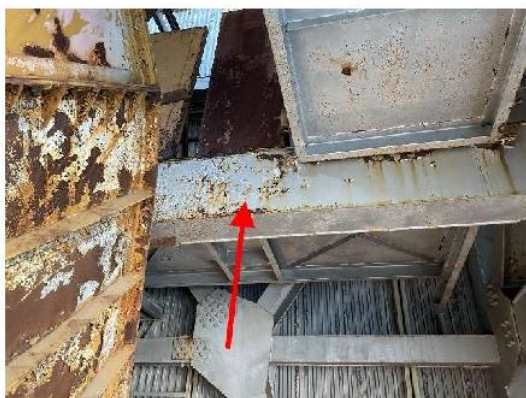
Vada č. 8 – častá vada – koroze hlavní nosné konstrukce
