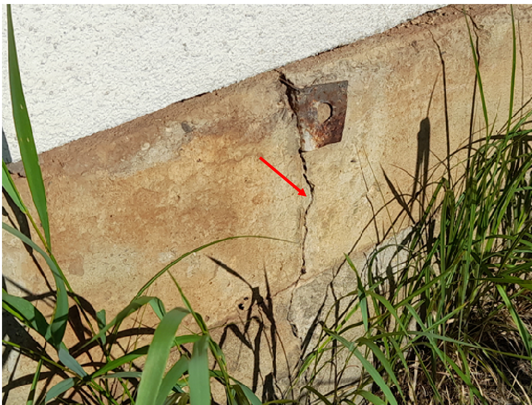
Obr. 49 Trhlina v základovém pasu
