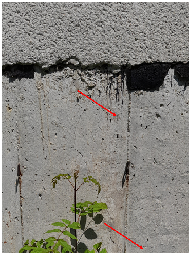
Obr. 39 Praskliny základového pasu
