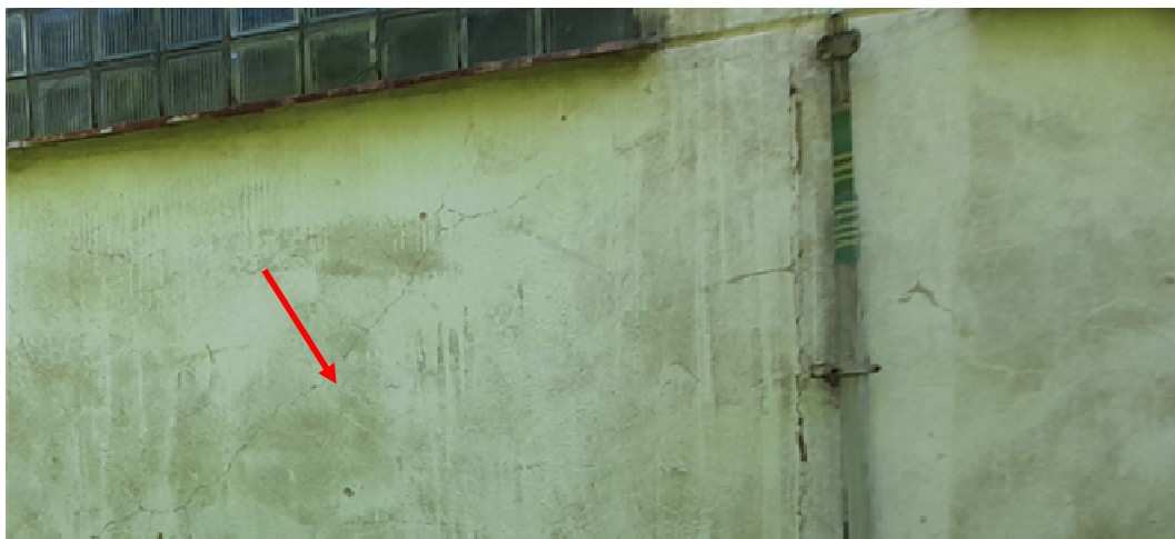
Obr. 106 Vlášková trhlina v omítce panelu obvodového pláště
