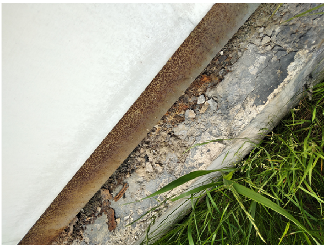
Obr. 13 Degradace betonu základové konstrukce
