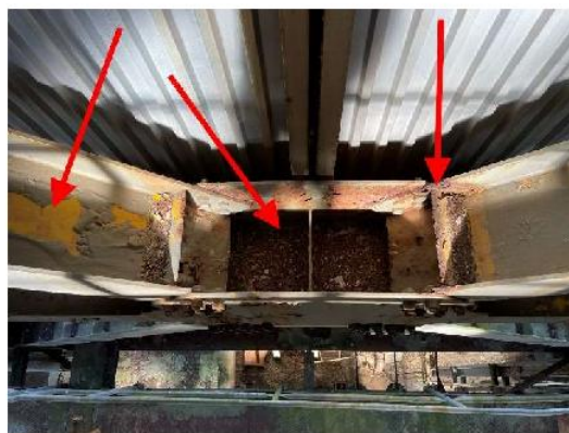
Vada č. 8 – častá vada – nevhodné detaily styčnicků – tvoří kapsy
