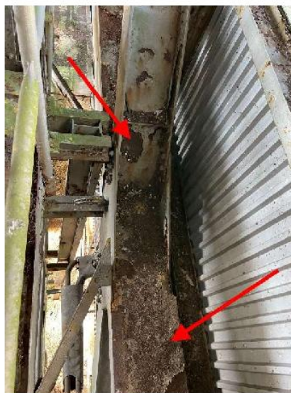
Vada č. 13 – častá vada – nevhodné detaily styčníků – tvoří kapsy
