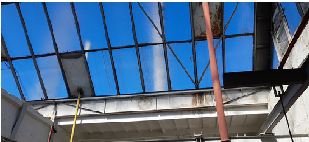
Obr. 98 Střešní světlík – pro nové využití objektu nevhodné z důvodu tepelně-technických parametrů
