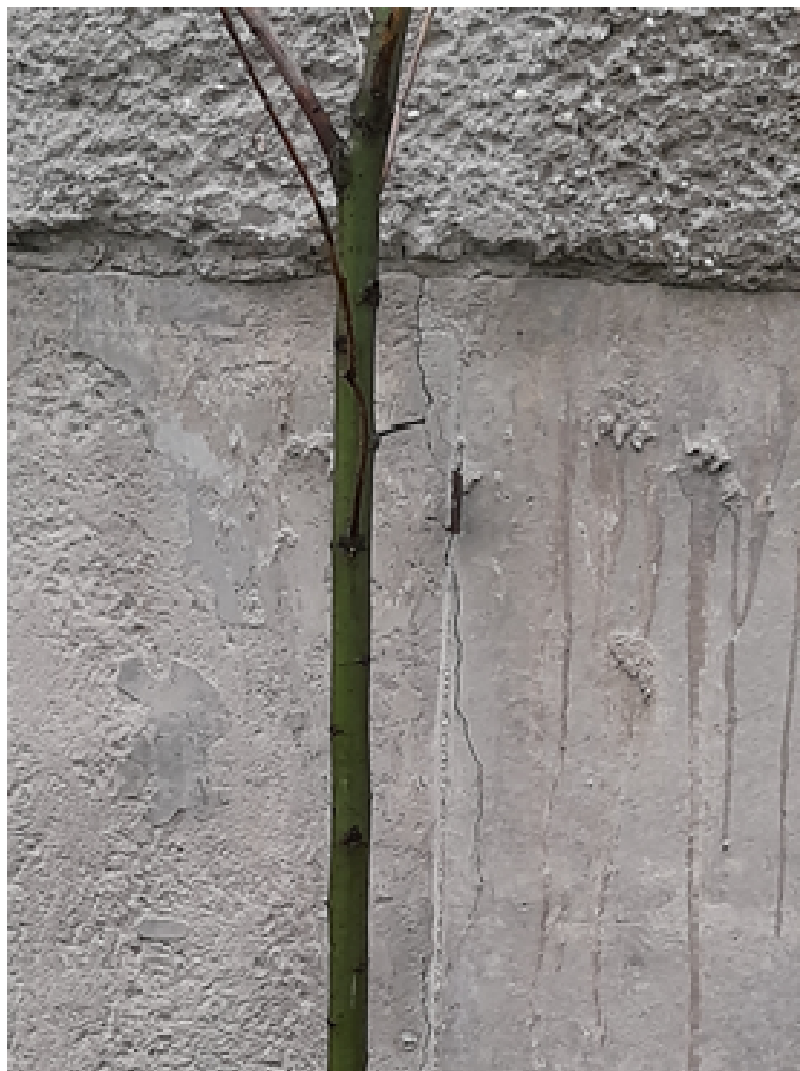
Obr. 23 Trhlina v základovém pasu
