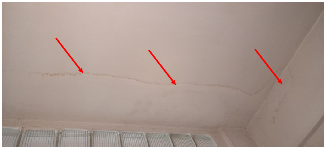
Obr. 152 Strop nad 4.NP – lokálně stopy po (nejspíše) dřívějším zatékání střešním pláštěm
