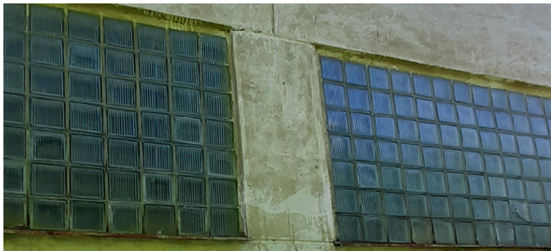
Obr. 115 Omítky a malba narušené a znečištěné
