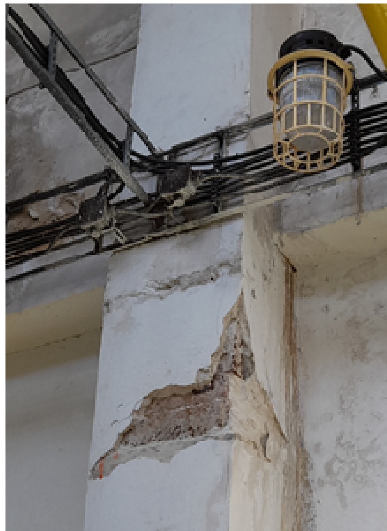
Obr. 70 Opadaná omítka na sloupu na styku hlavního objektu a přístavby – nejspíše vlivem pronikání vlhkosti ze střechy přístavku
