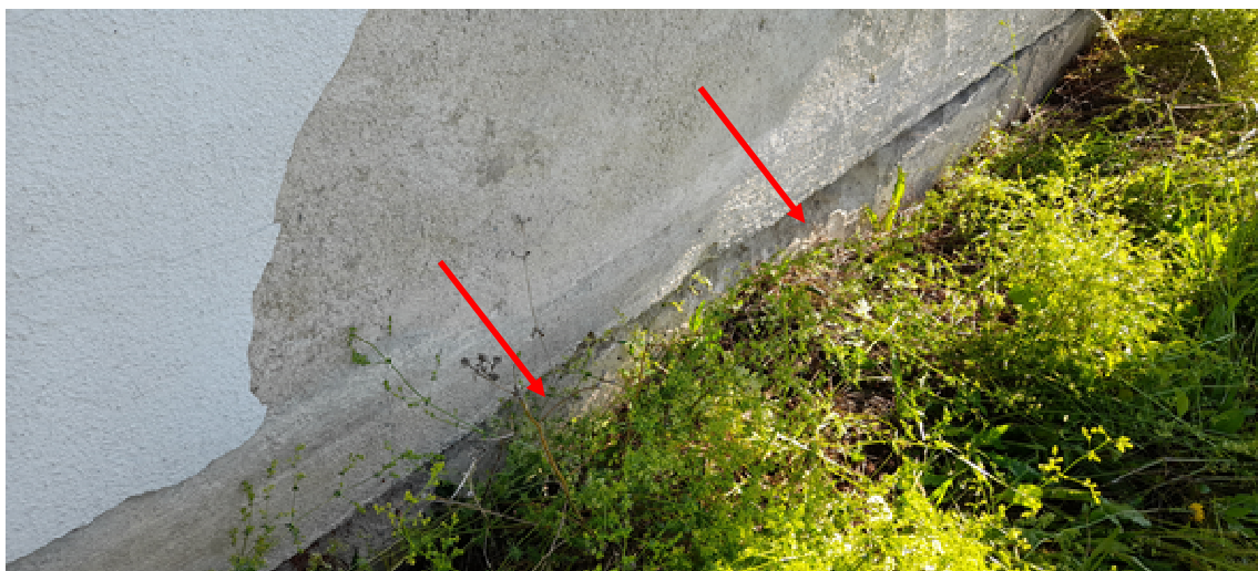
Obr. 134 Část základové konstrukce s degradovanou horní částí betonu
