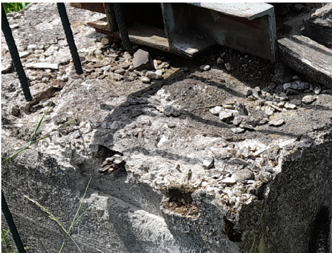
Obr. 44 Degradace betonu základové konstrukce
