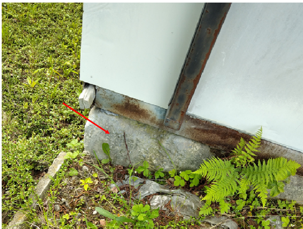
Obr. 12 Degradace betonu základové konstrukce
