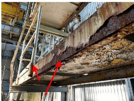
Vada č. 2 – častá vada – nadměrná koroze plošinových nosníků
