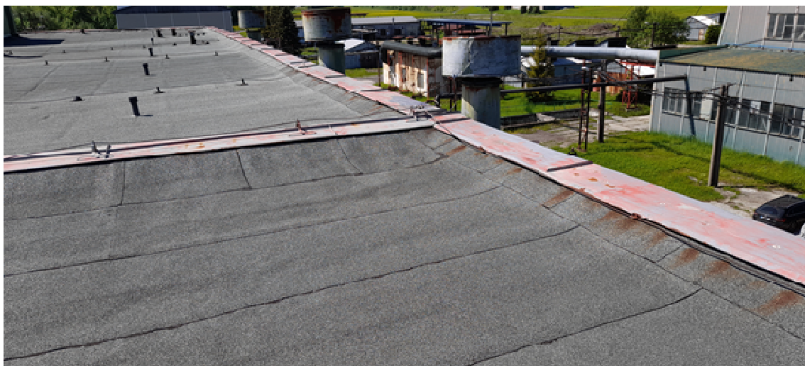
Obr. 146 Oplechování a další klempířské konstrukce částečně korodují – nutná údržba
