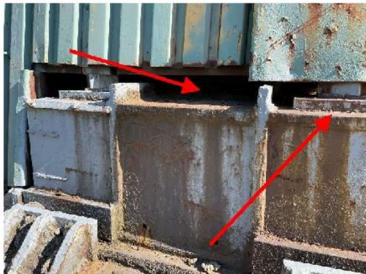
Vada č. 1 – častá vada – koroze v kotvení
