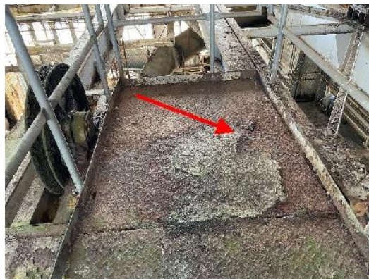
Vada č. 3 – častá vada – nadměrná koroze pochozích plechů
