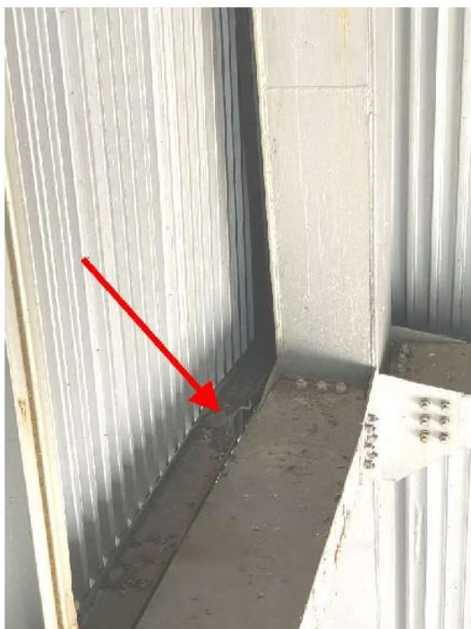
Vada č. 14 – deformace a výpal paždiku, osa A nad mezipodestou v úrovni nad +15,0 m
