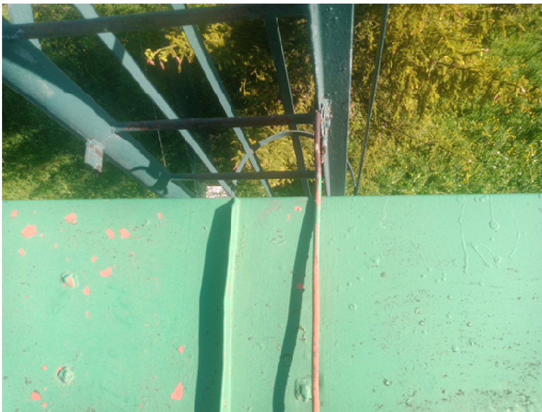
Obr. 78 Oplechování a klempířské prvky - revizní žebřík není dostatečně uchycený
