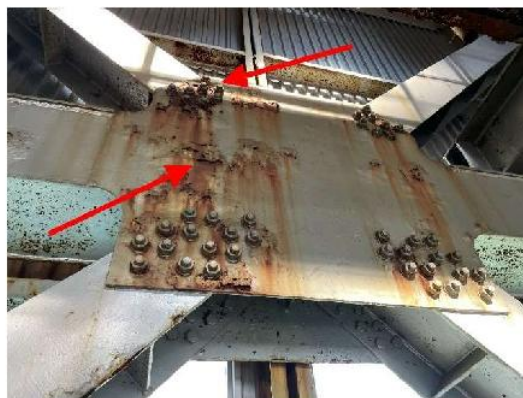
Vada č. 4 – častá vada – koroze styčnickových plechů
