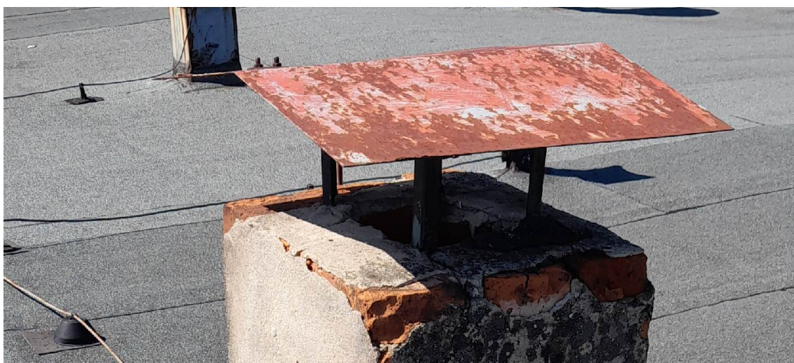
Obr. 147 Klempířské konstrukce korodují – nutná údržba, rovněž nutná sanace zděné konstrukce
