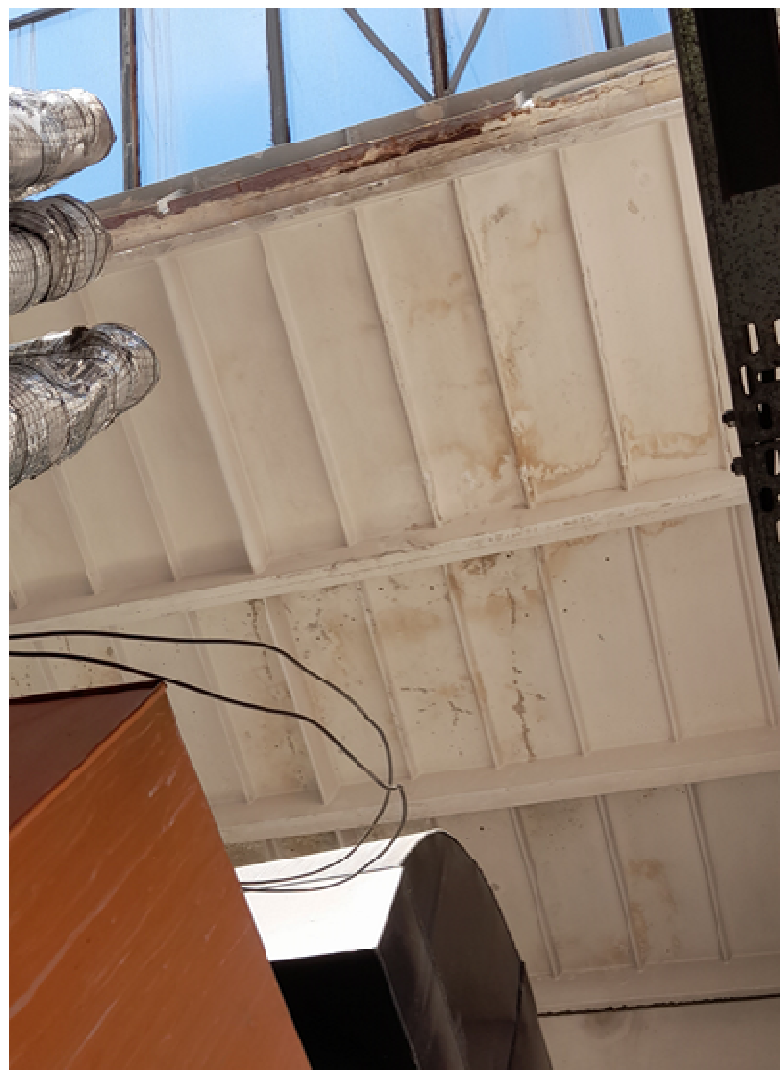
Obr. 72 Lokální vlhkostní porucha stropního panelu
