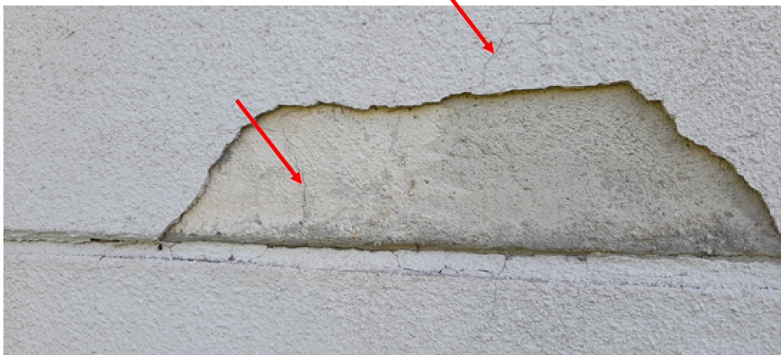
Obr. 161 Praskliny v omítce panelu probíhání až do panelu samotného
