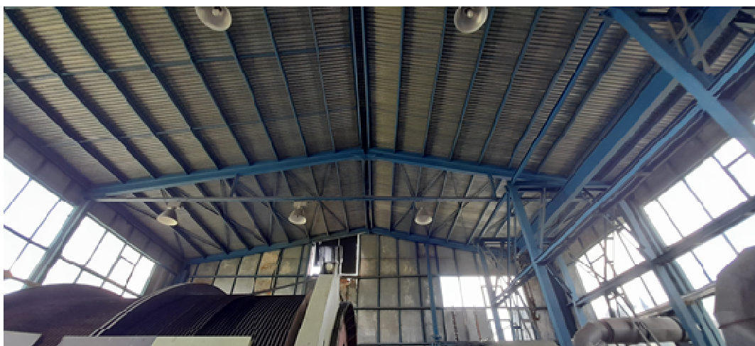
Obr. 123 Pohled na staticky nevyhovující konstrukci zastřešení
