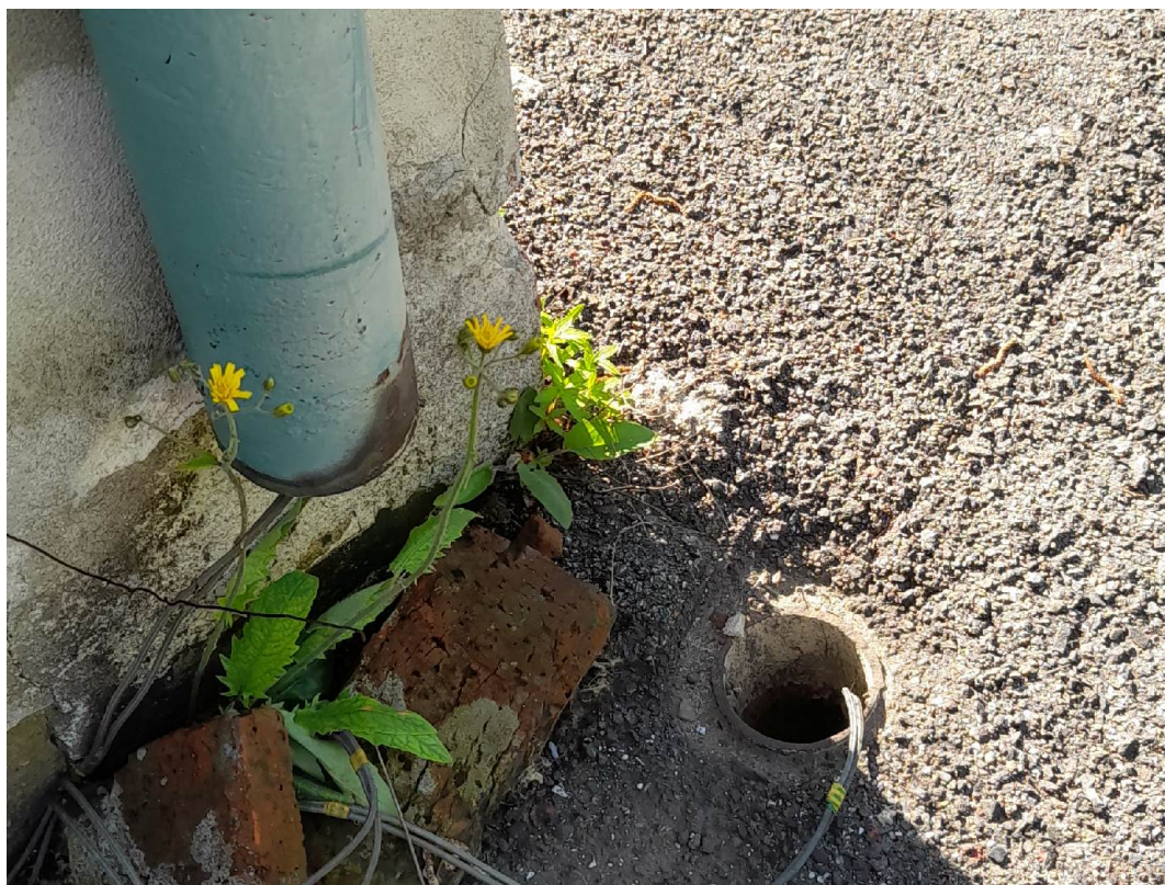
Obr. 79 Svody dešťové vody nejsou přímo napojeny na dešťovou kanalizaci a smáčí fasádu
