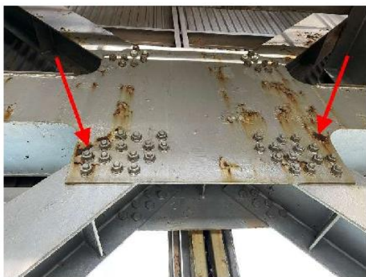
Vada č. 7 – častá vada – koroze styčnickových plechů
