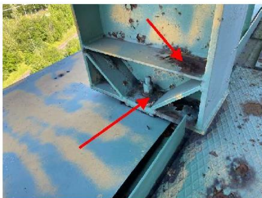
Vada č. 20 – častá vada – koroze v kotvení vnější konstrukce
