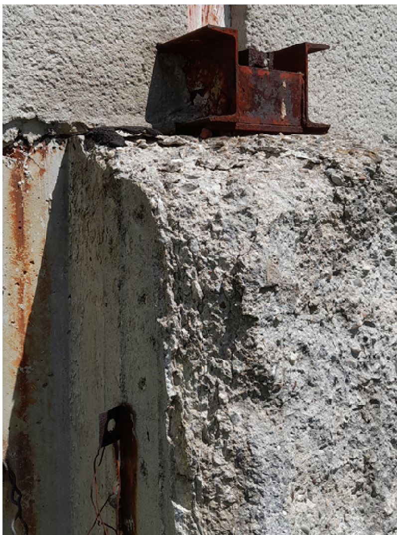
Obr. 37 Degradace betonu základové patky
