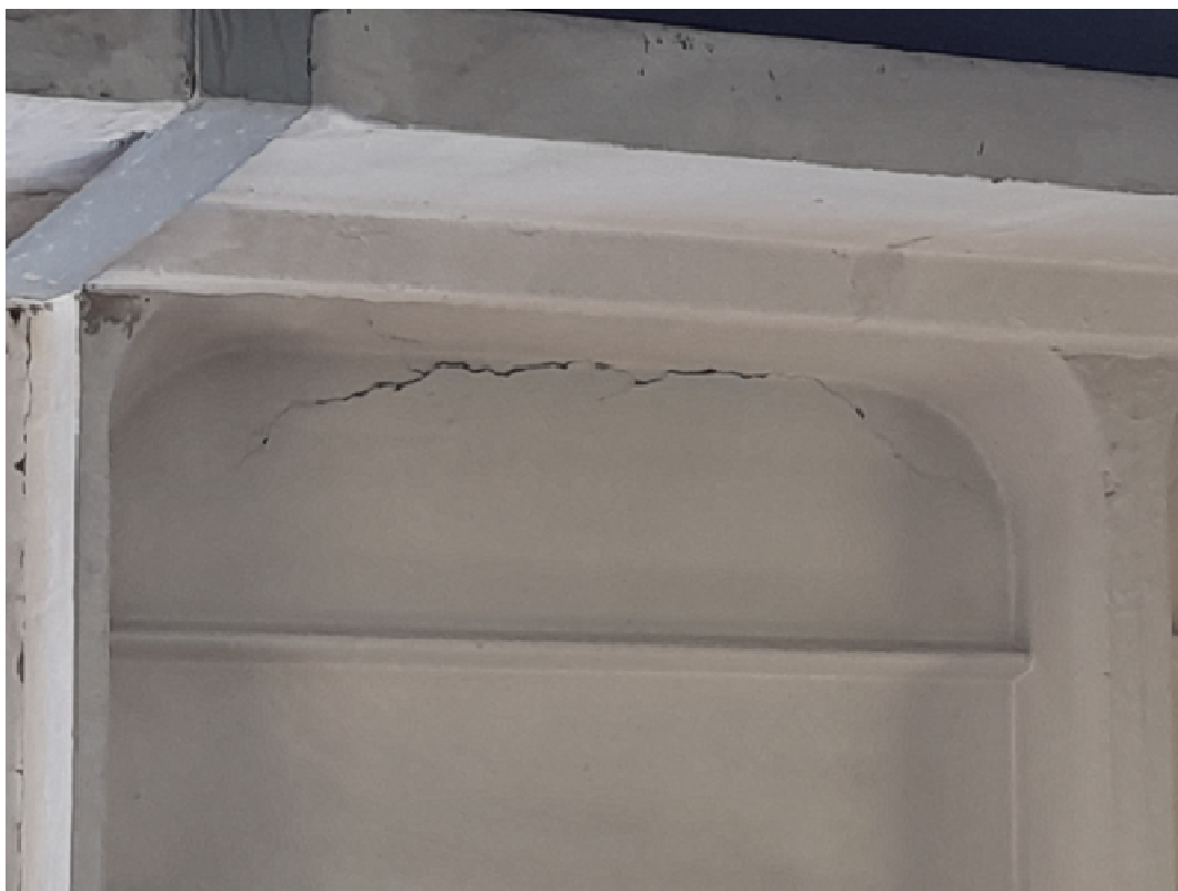
Obr. 58 Trhlina v krajní části prefabrikovaného železobetonového žebírkového panelu
