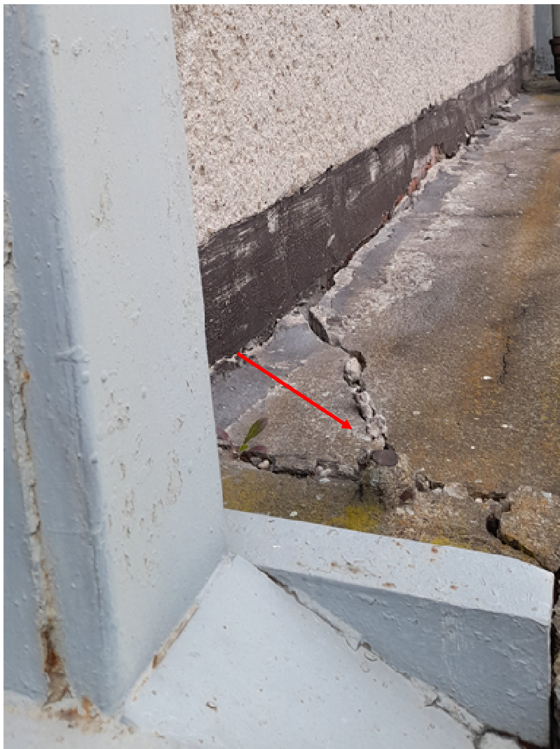
Obr. 31 Odtřzení podlahy rampy od hlavní budovy
