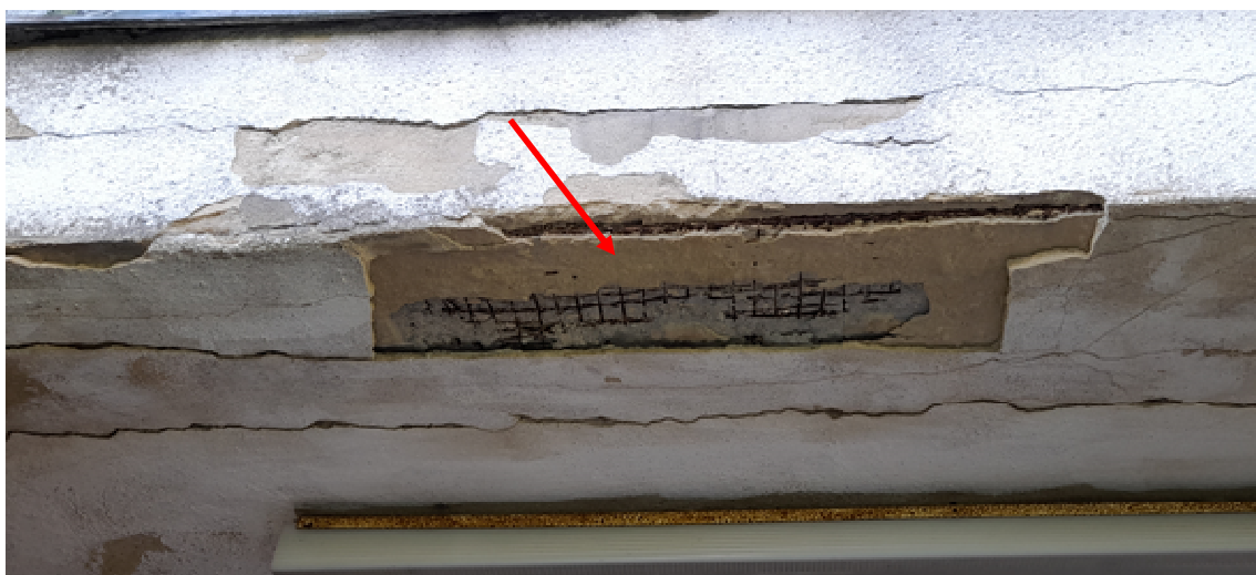
Obr. 158 Nesoudržná a opadaná omítka vlivem stékání dešťové vody na fasádu z oplechování
