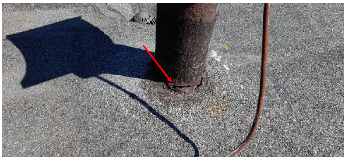
Obr. 144 Nesprávně provedený vstup střešním pláštěm – riziko zatékání
