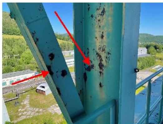
Vada č. 16 – častá vada – koroze hlavních nosných konstrukcí vnější konstrukce střechy
