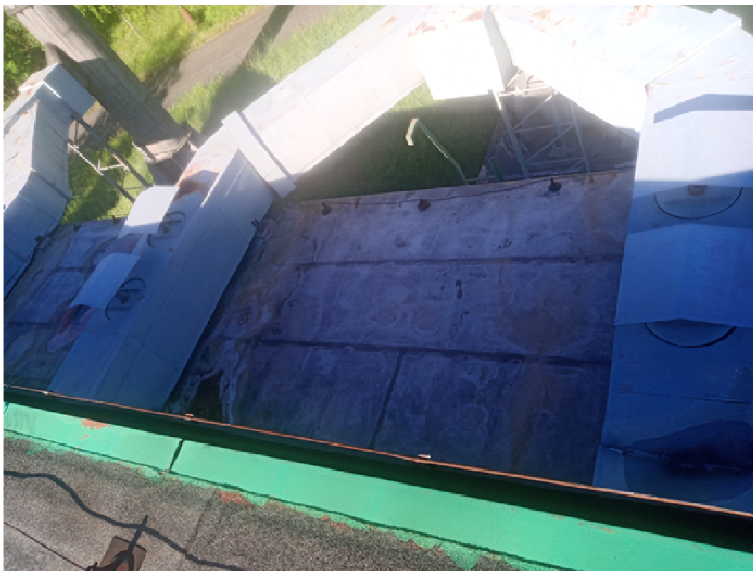
Obr. 76 Krytina na přístavku k opravě / rekonstrukci
