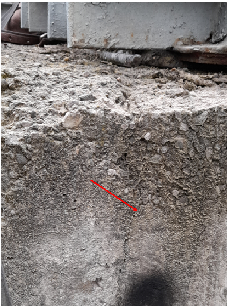
Obr. 30 Trhlina v rohové základové patce
