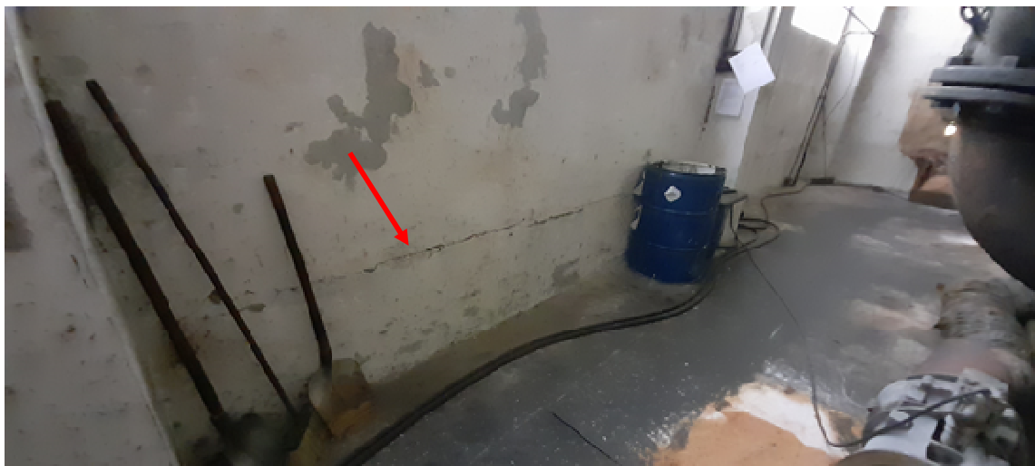
Obr. 109 Vodorovná prasklina na rozhraní materiálů
