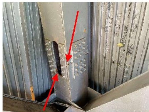
Vada č. 19 – častá vada – plátová koroze profilů ve svislých spojích
