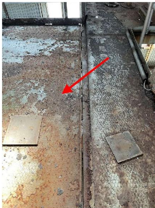
Vada č. 11 – častá vada – nadměrná koroze pochozích plechů
