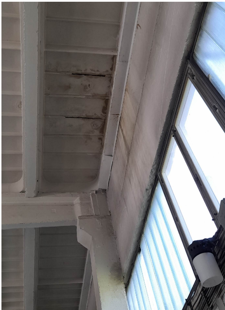
Obr. 71 Lokální vlhkostní porucha stropního panelu s obnaženou zkorodovanou výztuží
