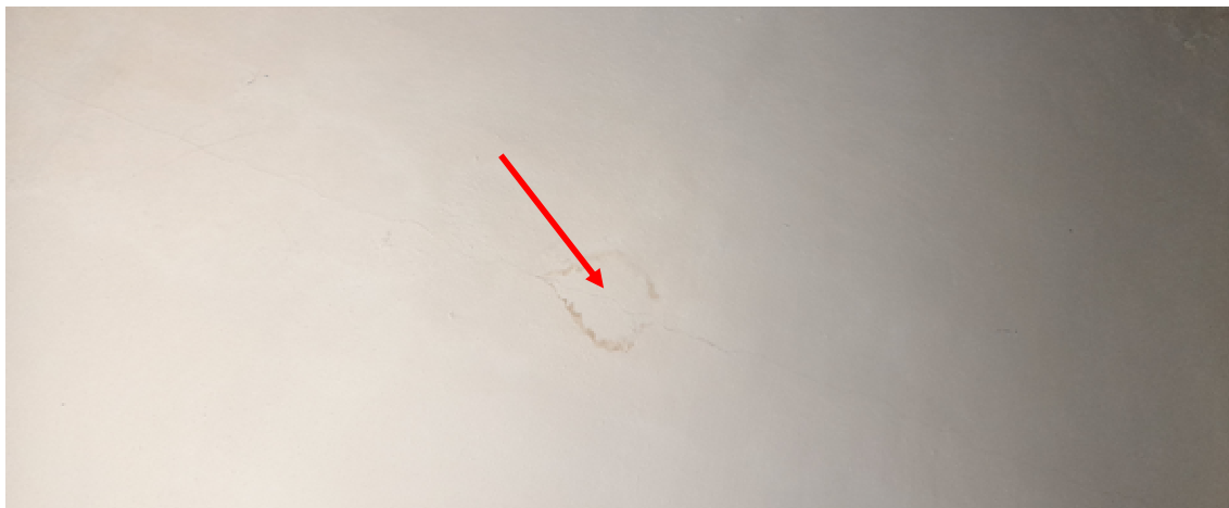
Obr. 151 Strop nad 4.NP – lokálně stopy po (nejspíše) dřívějším zatékání střešním pláštěm
