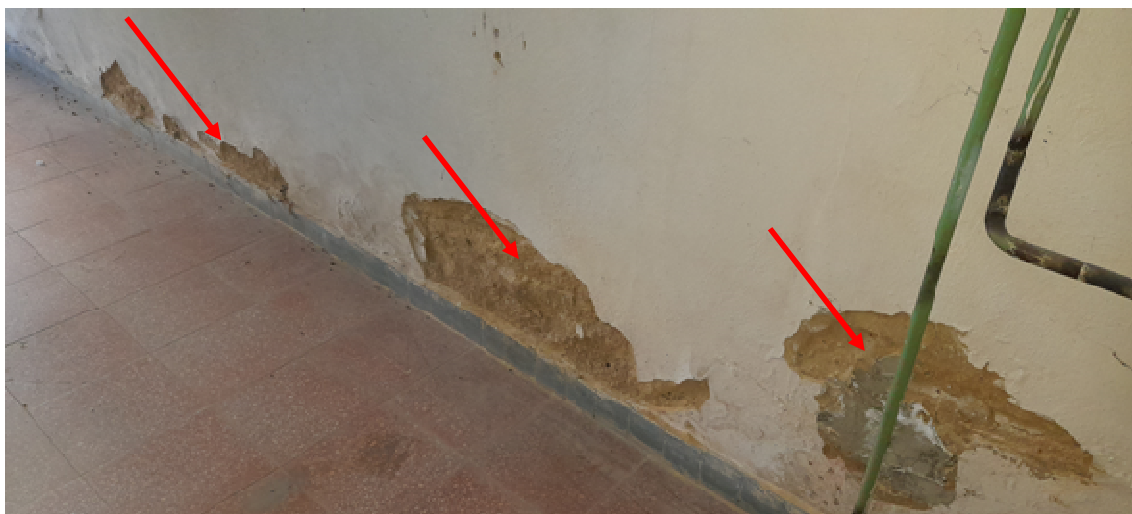
Obr. 153 1.NP – vlhkostní poruchy zdiva v 1.NP – nejspíše nefunkční vodorovná hydroizolační vrstva
