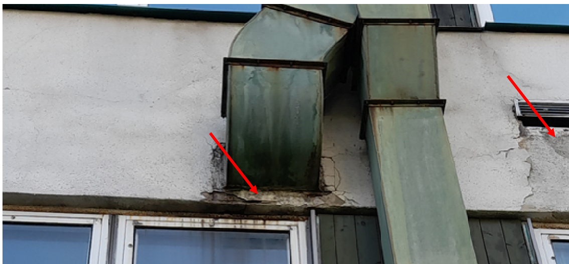
Obr. 156 Nesoudržná a opadaná omítka vlivem stékání dešťové vody na fasádu z technologických částí
