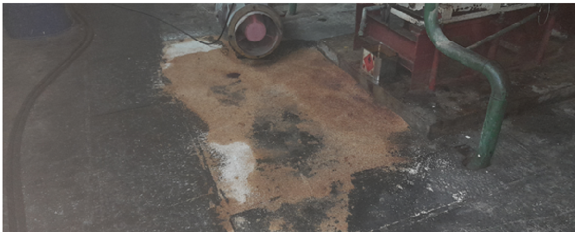
Obr. 116 Olejová skvrna na podlaze
