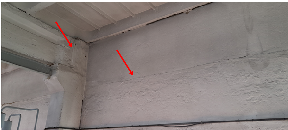
Obr. 60 Trhliny na rozhraní materiálů (vyzdívka x ŽB průvlak, sloup x průvlak apod.) - bez vlivu na statiku objektu
