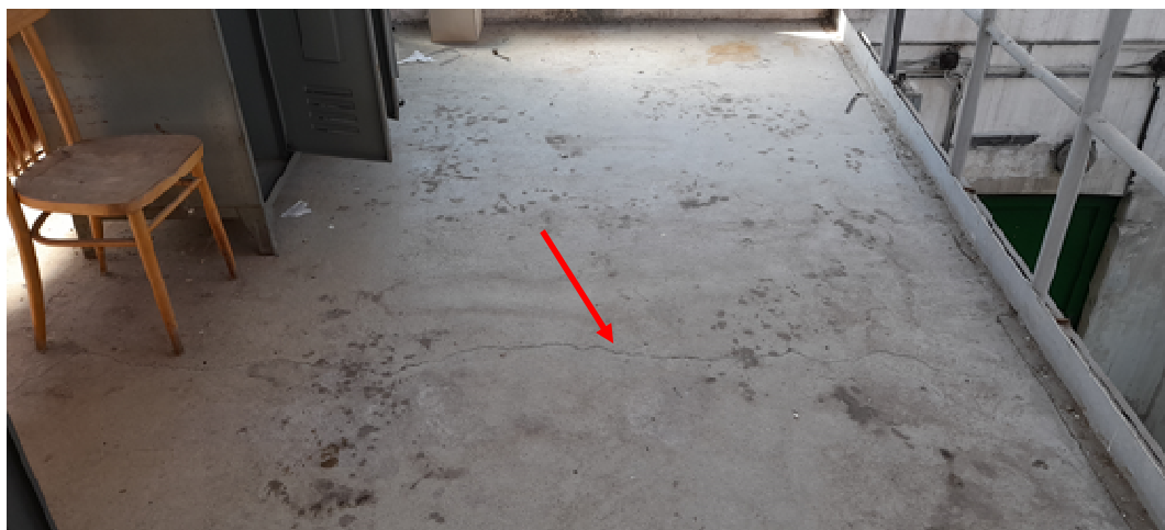
Obr. 59 Vlášenková trhlina ve stropní desce nad zázemím pro personál
