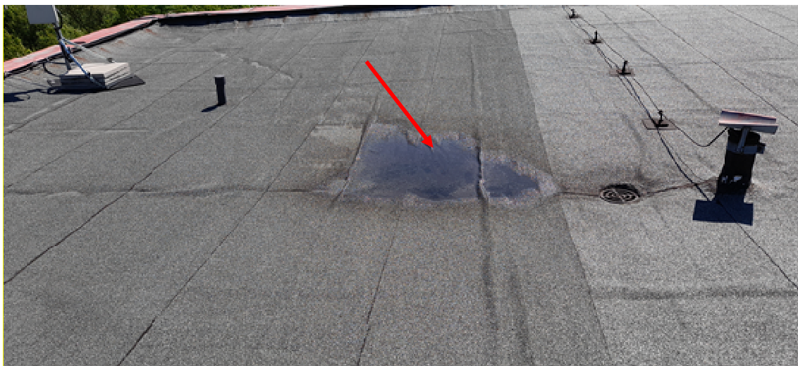
Obr. 141 Chyba ve spádování krytiny – dešťová voda lokálně neodtéká
