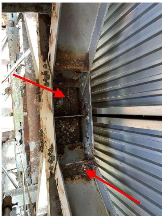
Vada č. 13 – častá vada – nevhodné detaily styčniců – tvoří kapsy
