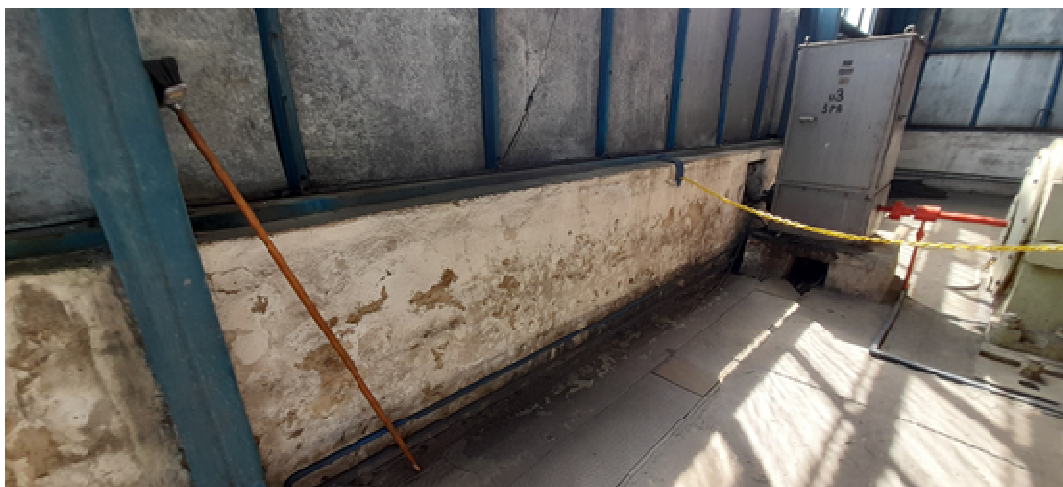
Obr. 124 Degradace vyzdívky obvodového parapetního zdiva
