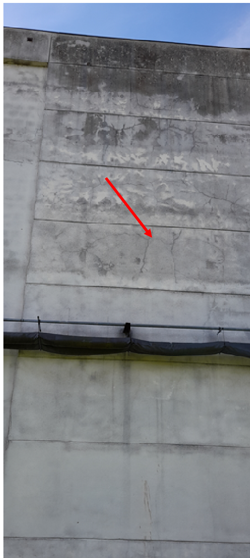
Obr. 166 Krajní panelové části severní a jižní fasády rovněž s prasklinami
