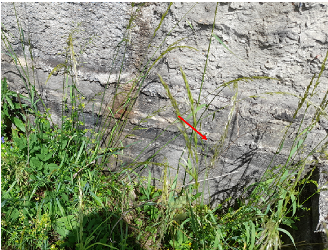
Obr. 43 Vlášenková trhlinka v základovém pasu
