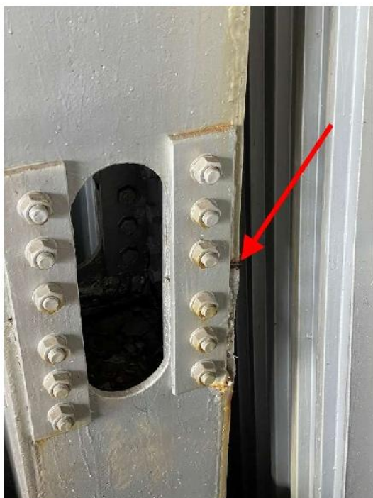
Vada č. 10 – častá vada – plátová koroze profilů ve svislých spojích
