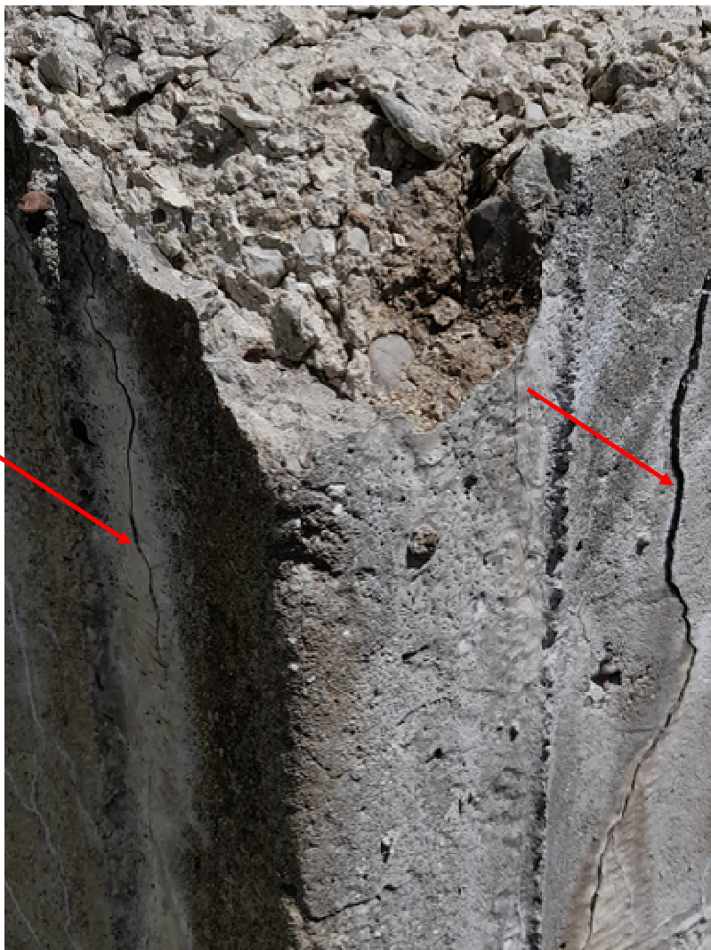
Obr. 38 Degradace betonu základové patky a praskliny vlivem smáčení
