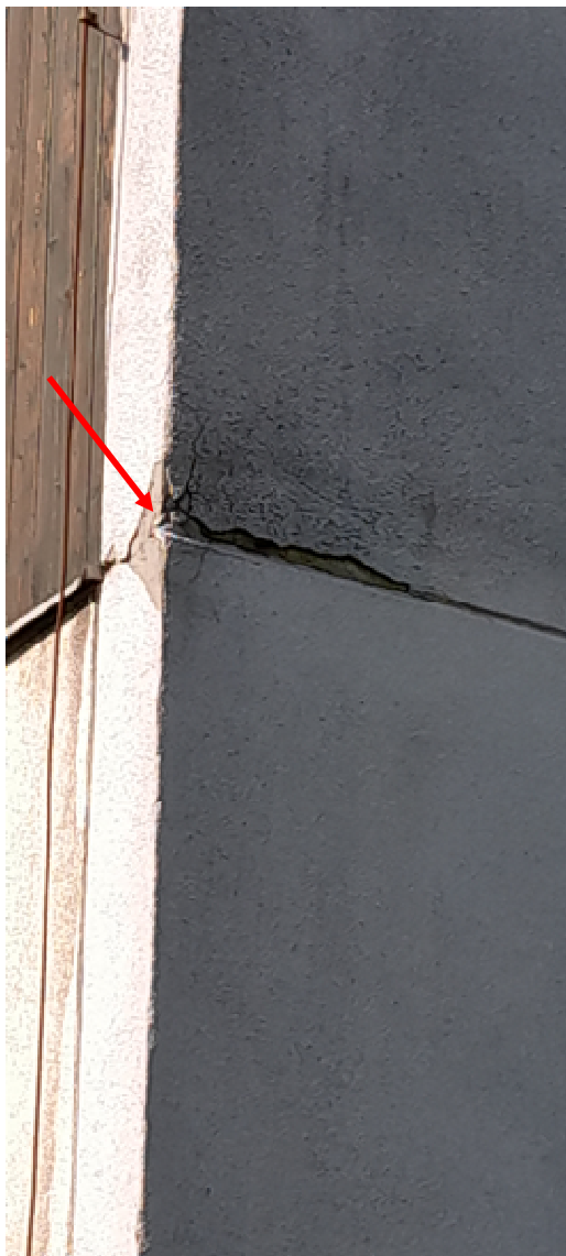
Obr. 165 Nesoudržná a opadaná omítka vlivem stékání dešťové vody po fasádě
