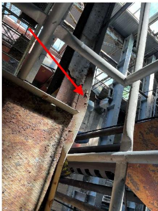
Vada č. 16 – deformovaný okopový plech, v úrovni +11,0 m
