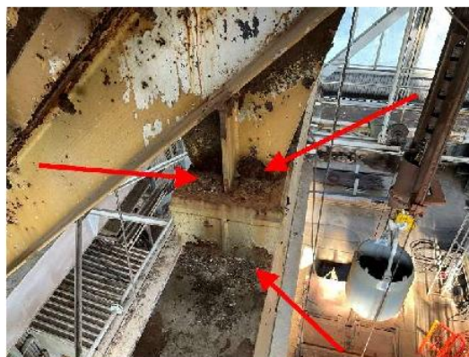
Vada č. 14 – častá vada – koroze detailů uložení sýpy, koroze šroubů
