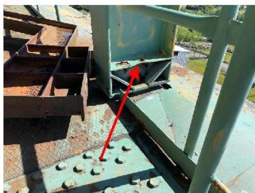
Vada č. 24 – deformace výztuhy, osa B v úrovni +35,0 m
