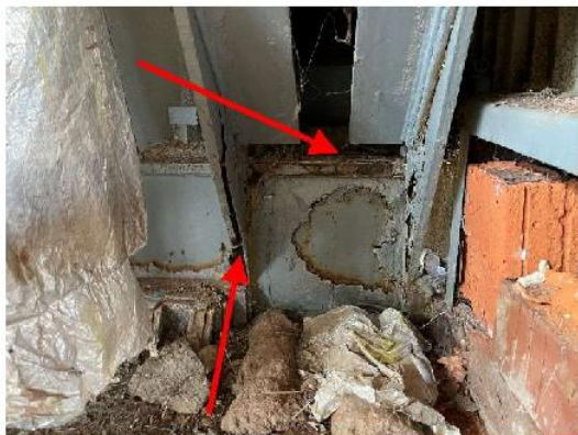
Vada č. 3 – častá vada – koroze v kotvení
