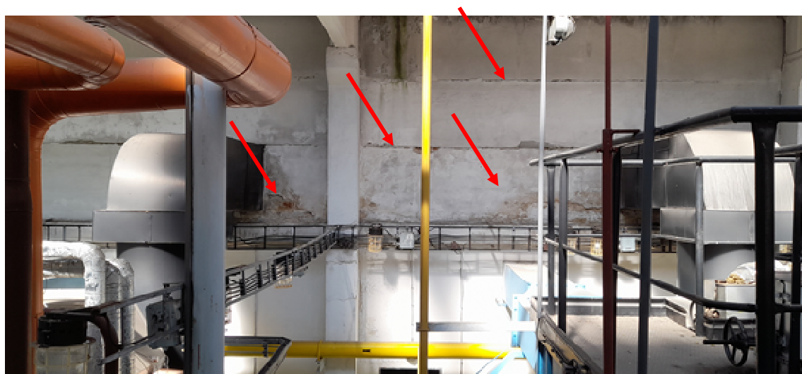
Obr. 61 Trhliny na rozhraní materiálů a vlhkostní poruchy v místě styku ŽB průvlaku a prostupů VZT
