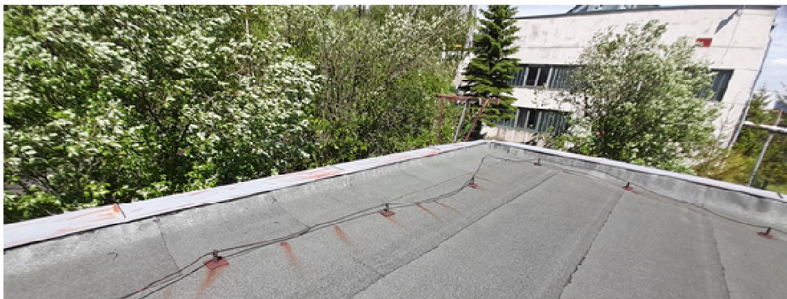
Obr. 111 Oplechování s lokální korozí
