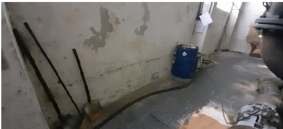
Obr. 114 Omítky a malba narušené a znečištěné
