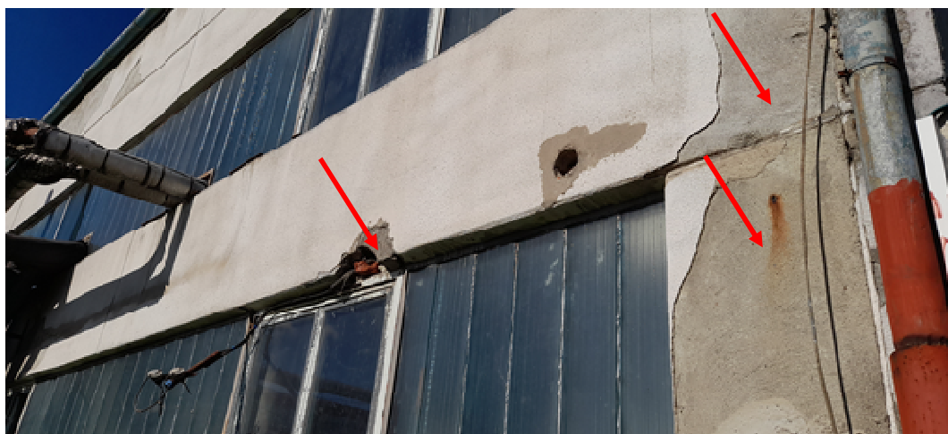
Obr. 91 Opadaná omítka panelů, částečně vyspravená, vlásenkové praskliny omítky panelů
