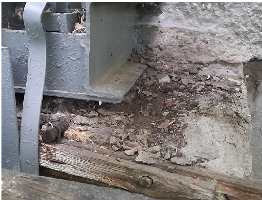
Obr. 21 Obnažená výztuž, chybějící/degradovaná zálivka pod patou sloupu
