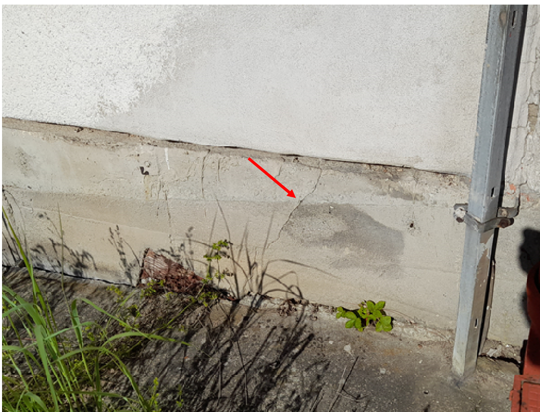
Obr. 48 Vlášková trhlina v základovém pasu – spoj pasu a patky v rohu budovy
