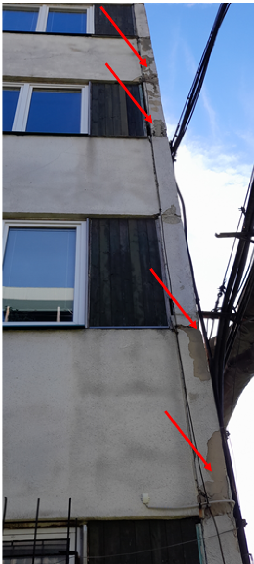
Obr. 168 Nesoudržná a opadaná omítka vlivem stékání dešťové vody po fasádě
