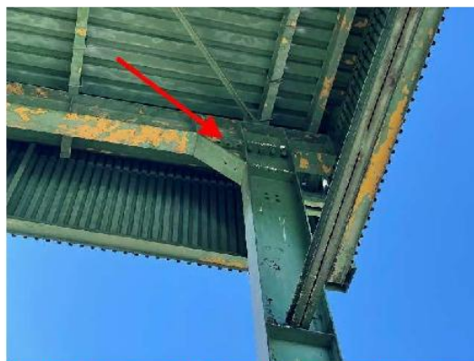
Vada č. 23 – chybějící šrouby v rámových rozích vnější konstrukce střechy
