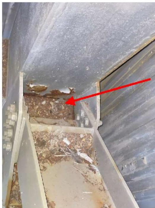
Vada č. 15 – častá vada – koroze ve styčnicích hlavní nosné konstrukce
