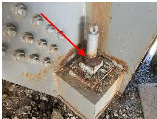
Vada č. 4 – častá vada – koroze v kotev
