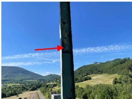
Vada č. 21 – častá vada – koroze vnější konstrukce
