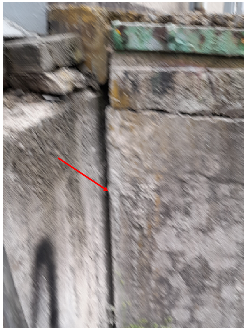
Obr. 32 Odtřzení podlahy rampy od hlavní budovy
