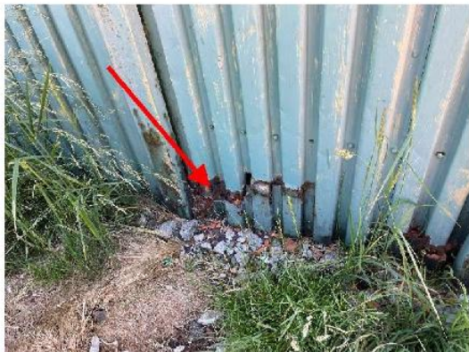
Vada č. 2 – častá vada – koroze opláštění
