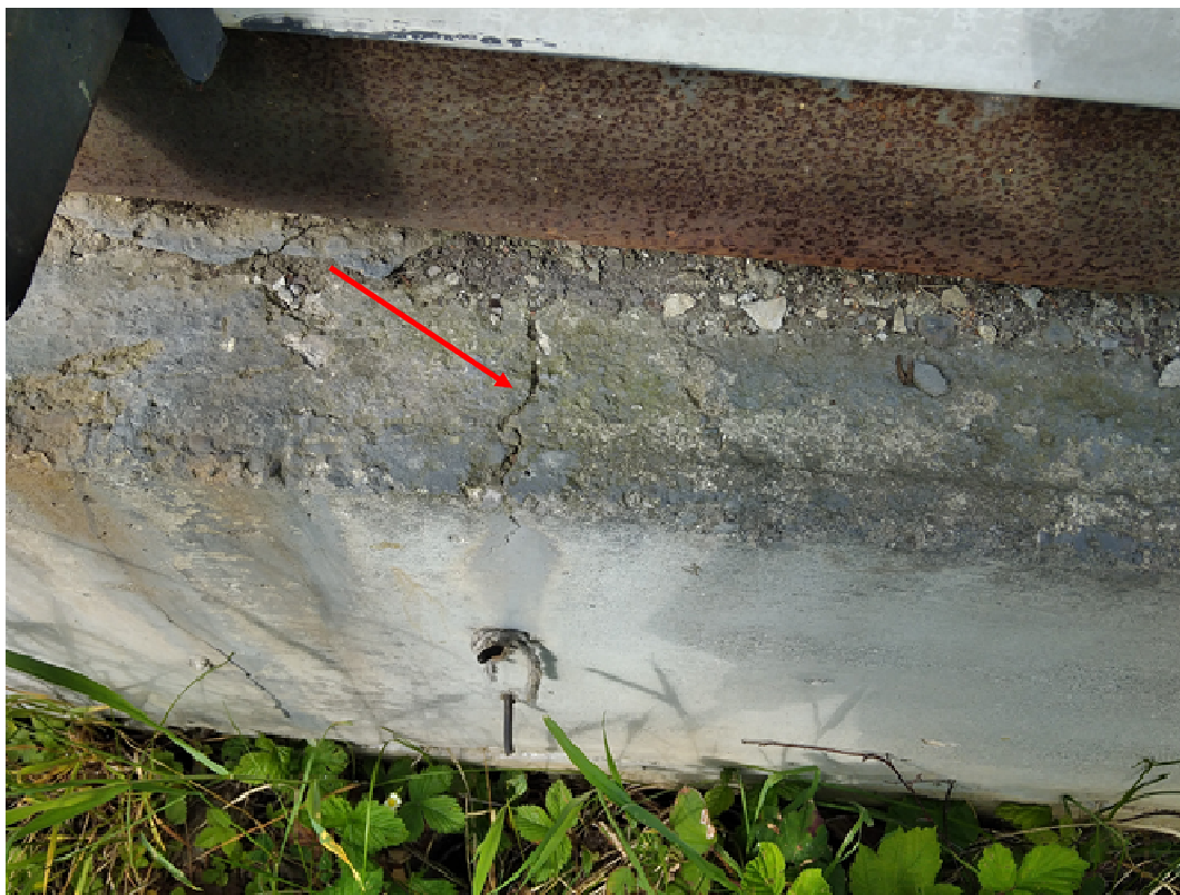
Obr. 11 Trhlina v základovém pasu
