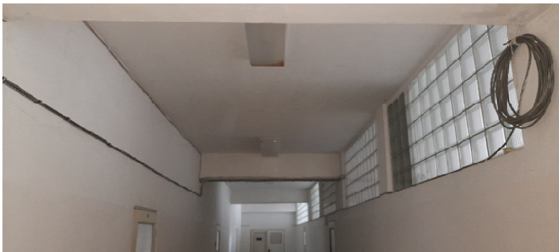
Obr. 150 Strop nad 4.NP – lokálně stopy po (nejspíše) dřívějším zatékání střešním pláštěm
