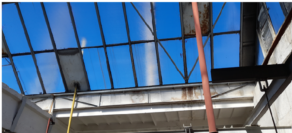
Obr. 68 Vlhkostní poruchy na stropní nosné konstrukci u napojení světlíku
