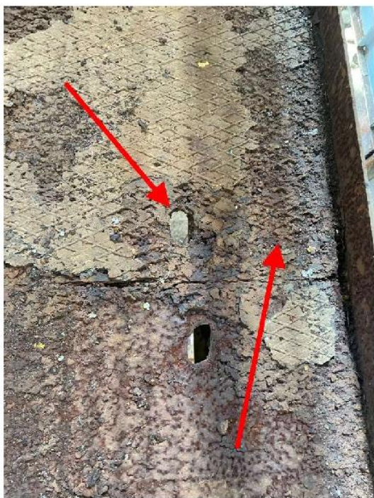
Vada č. 7 – častá vada – otvory v pochozí ploše, koroze podestových pochozích plechů
