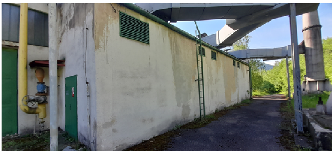
Obr. 93 Vlhký obvodový plášť a degradovaná omítka s prasklinami na rozhraní materiálů (ŽB rám x vyzdívka)
