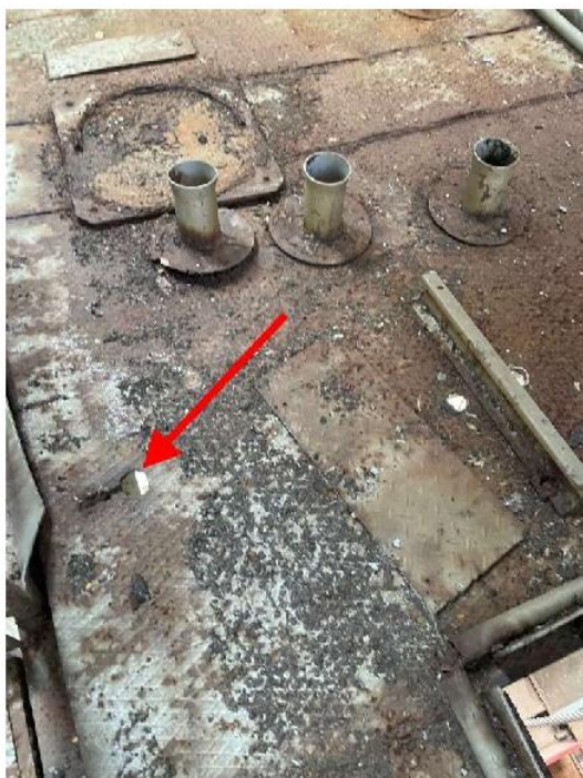
Vada č. 12 – častá vada – otvory v pochozí ploše, koroze podestových pochozích plechů
