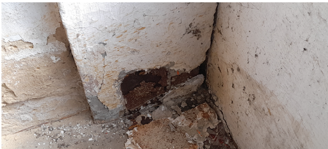
Obr. 63 Lokální vlhkostní poruchy v místě napojení sloupu na základovou patku
