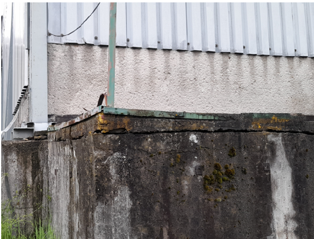
Obr. 33 Odtržení podlahy rampy od svislé nosné konstrukce a rampy od hlavní budovy
