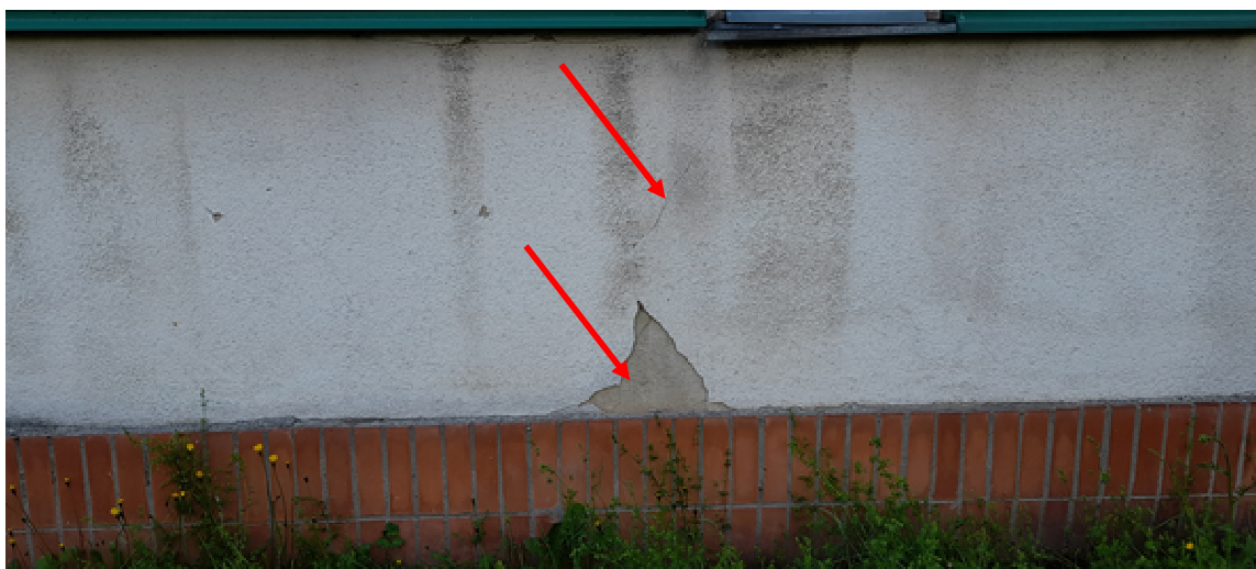
Obr. 135 Vypraskaná omítka i panel pod omítkou – prasklina směřuje ke kabřincem zakrytým základům
