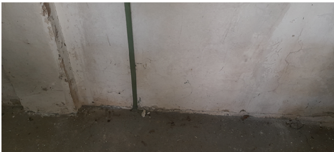
Obr. 66 Vlhkostní poruchy na svislé obvodové konstrukci přístavku
