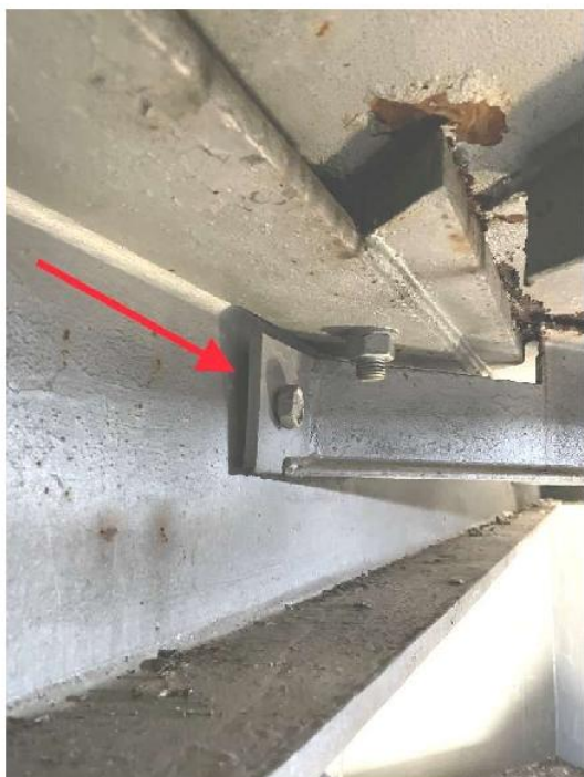
Vada č. 26 – volný šroub v úrovni pod plošinou +35,0 m
