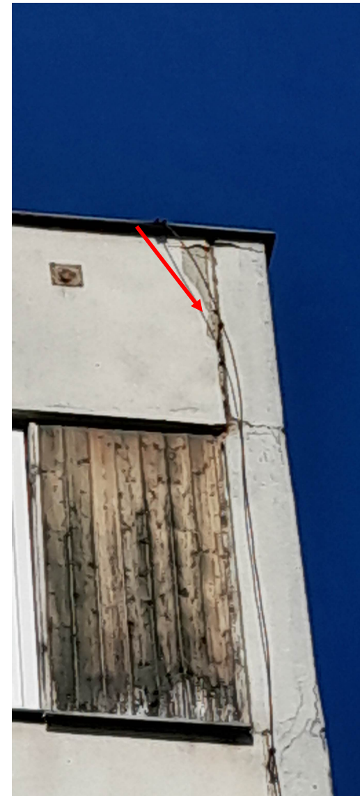
Obr. 167 Nesoudržná a opadaná omítka vlivem stékání dešťové vody na fasádu z oplechování
