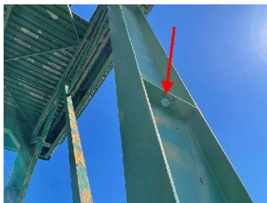
Vada č. 25 – výpal ve výztuže sloupu, osa B v úrovni +35,0 m
