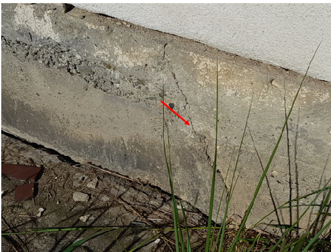
Obr. 50 Trhlina v základovém pasu – spoj pasu a patky
