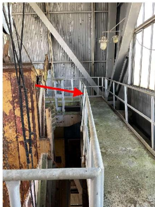
Vada č. 18 – deformované zábradlí na plošně v úrovni +15,0 m
