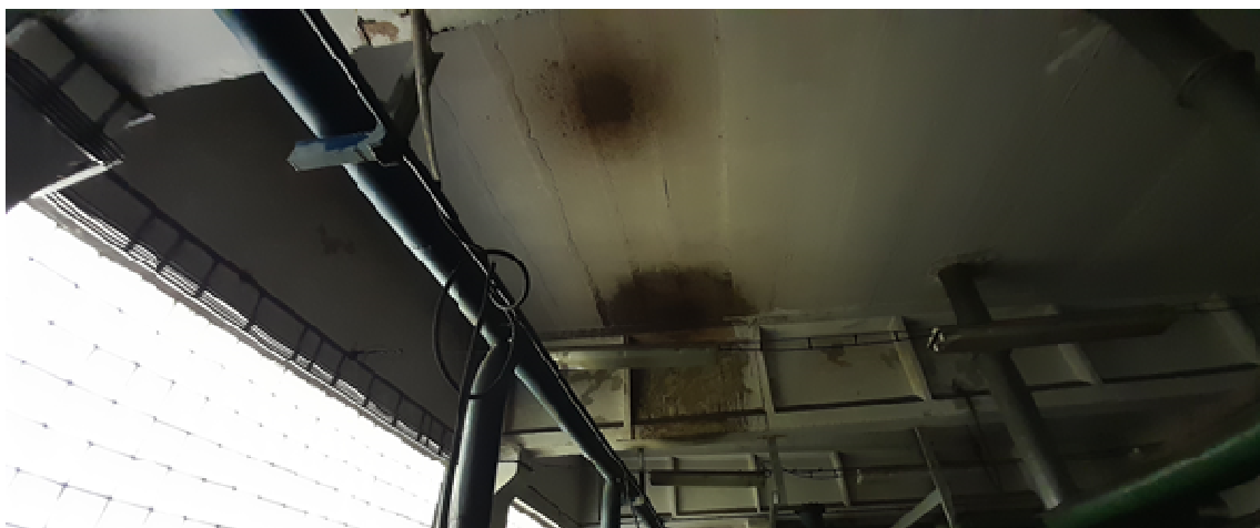
Obr. 118 Olejová skvrna na stropě
