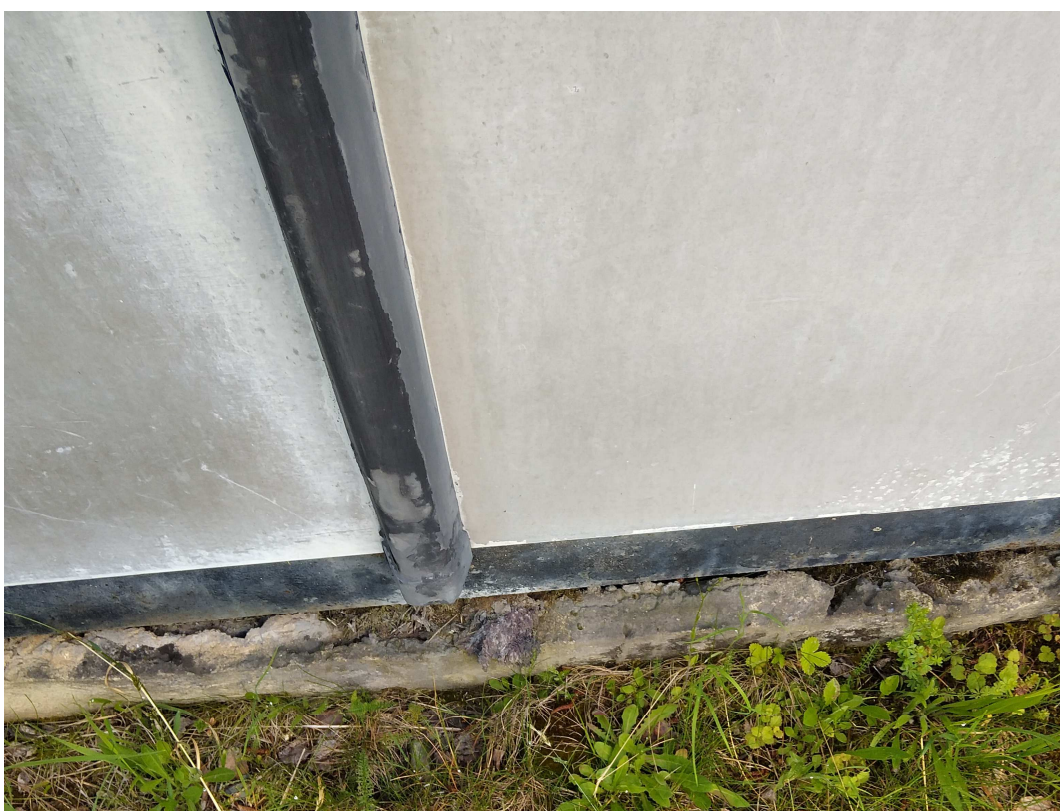
Obr. 14 Degradace betonu základové konstrukce a trhlina s rizikem odpadnutí krycí vrstvy výztuže
