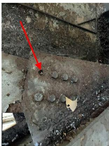
Vada č. 22 – chybějící šroub v úrovni pod plošinou +35,0 m
