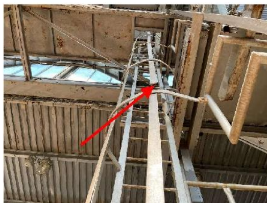
Vada č. 5 – utržený pásek bezpečnostního koše
