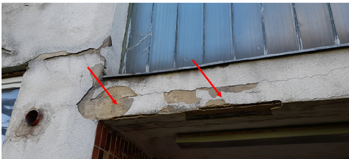
Obr. 157 Nesoudržná a opadaná omítka vlivem stékání dešťové vody na fasádu z oplechování
