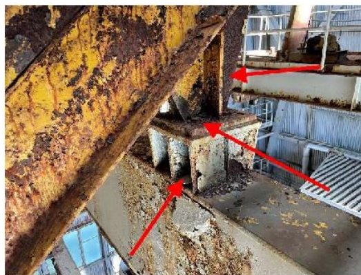
Vada č. 9 – častá vada – koroze detailů uložení sýpy, koroze šroubů
