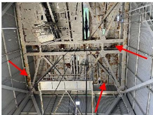
Vada č. 15 – častá vada – koroze hlavních nosných konstrukcí
