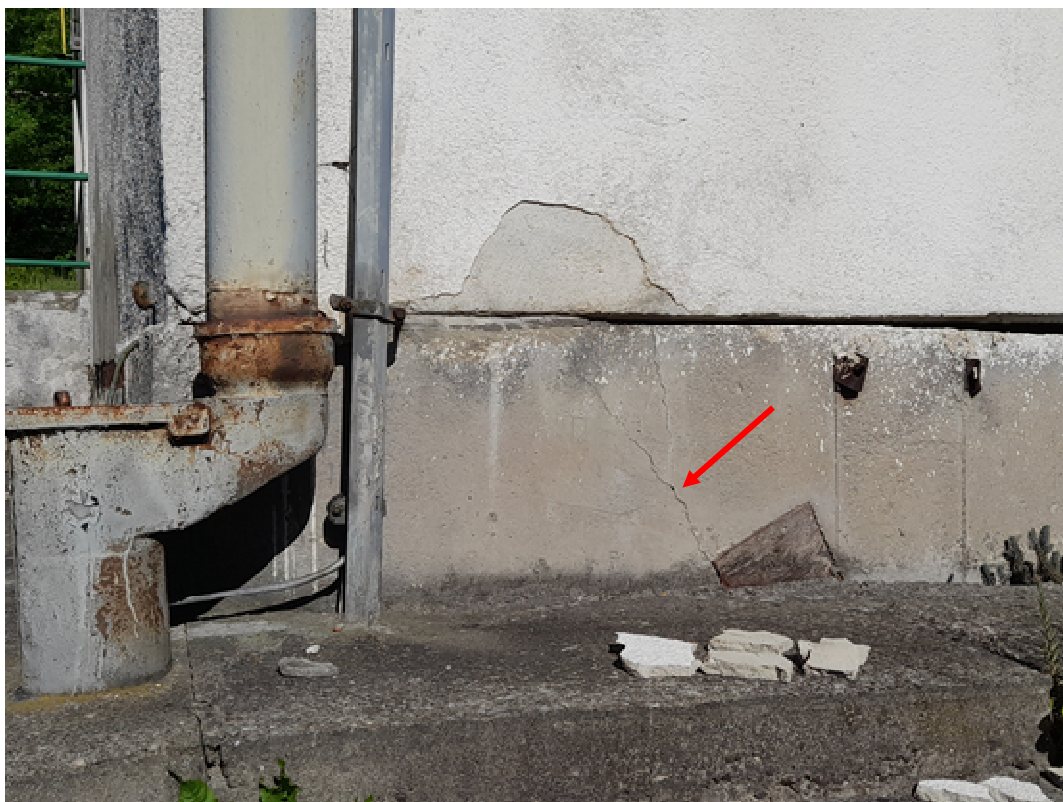
Obr. 51 Trhlina v základovém pasu – spoj pasu a patky
