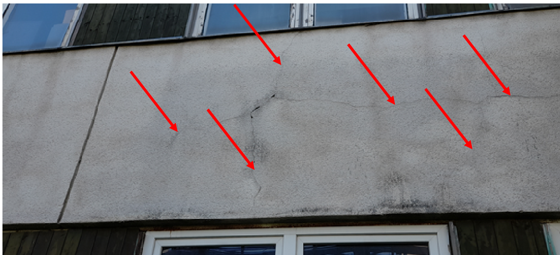
Obr. 154 Vypráskaná a nesoudržná omítka v ploše panelu
