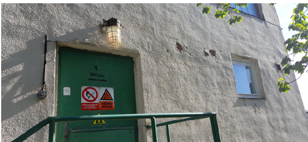
Obr. 96 Kovové vstupní dveře odpovídají charakteru objektu – pro nové využití objektu nejspíše nevyužitelné
