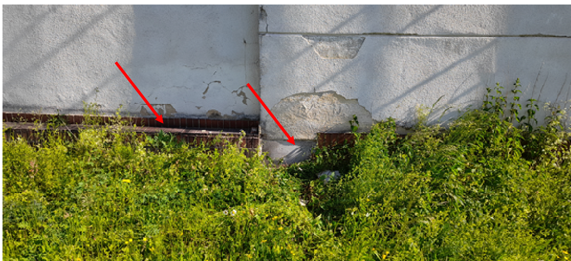
Obr. 133 Převážná část základové konstrukce je opatřena (lokálně odpadlým) obkladem
