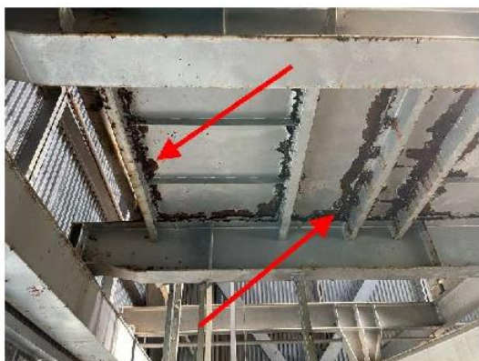
Vada č. 9 – častá vada – koroze plošinových nosníků a pochozích plechů
