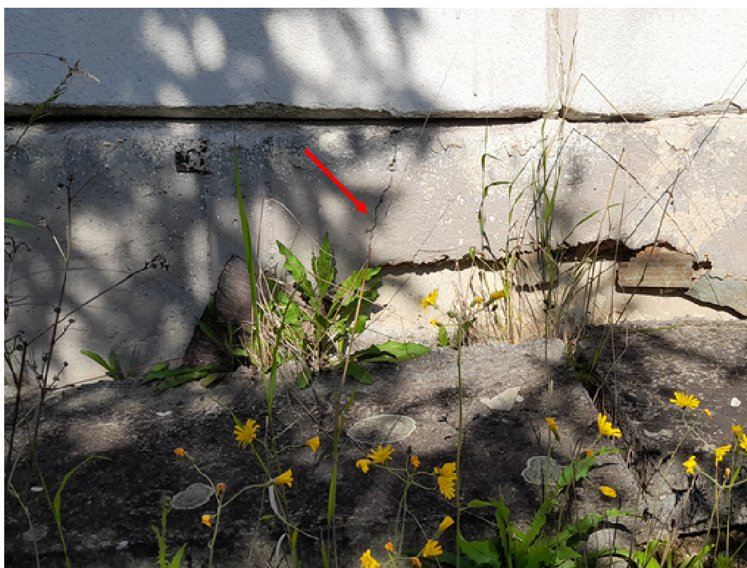
Obr. 52 Trhlina v základovém pasu – spoj pasu a patky
