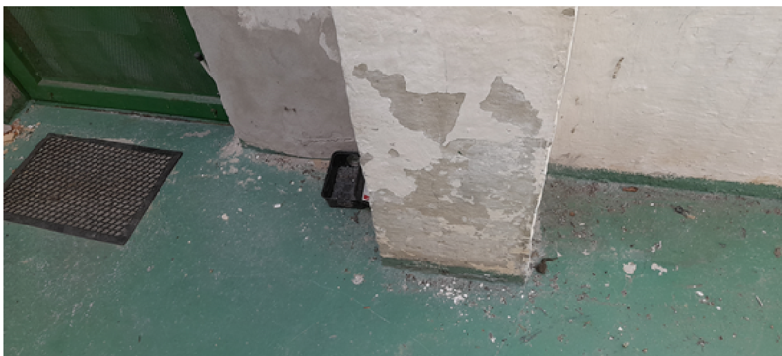
Obr. 67 Vlhkostní poruchy na svislé obvodové konstrukci a sloupech hlavního objektu
