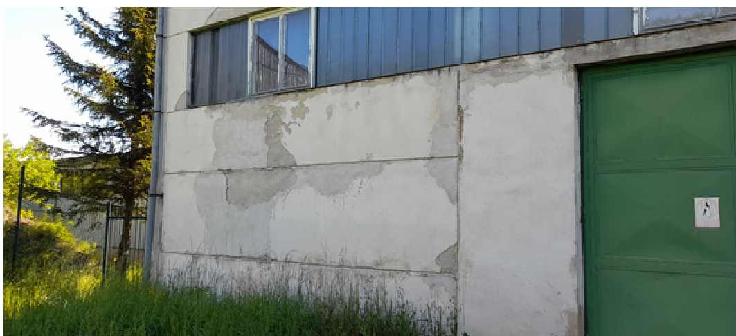
Obr. 94 Vlhký obvodový plášť a degradovaná omítka hlavního objektu
