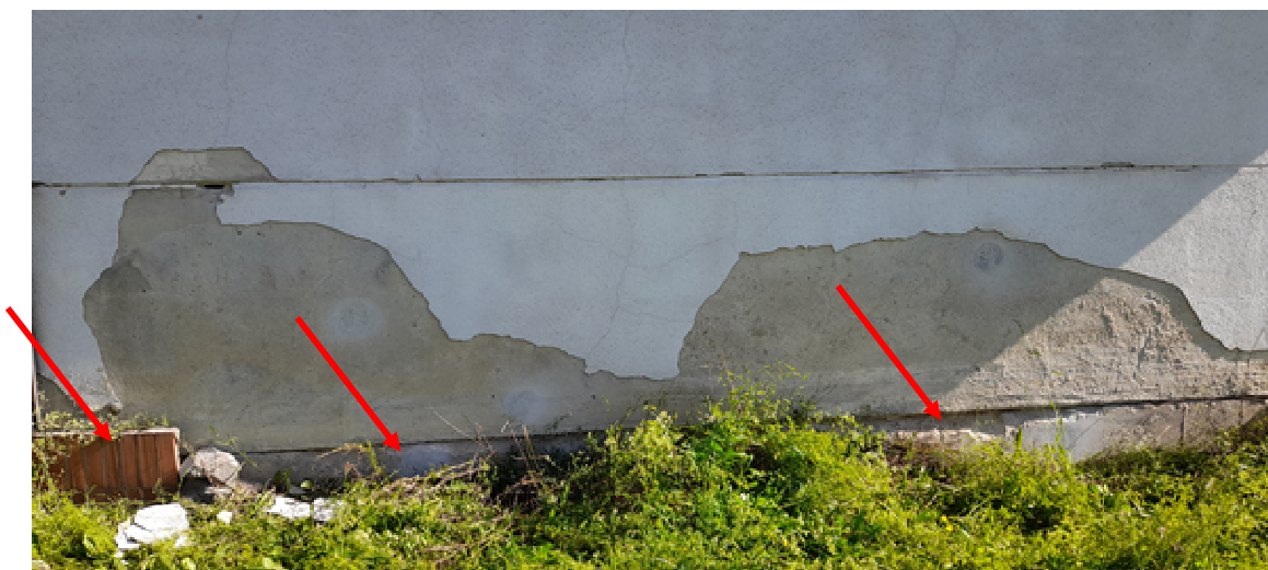
Obr. 132 Část základové konstrukce s opadnutým obkladem a degradovanou horní částí betonu
