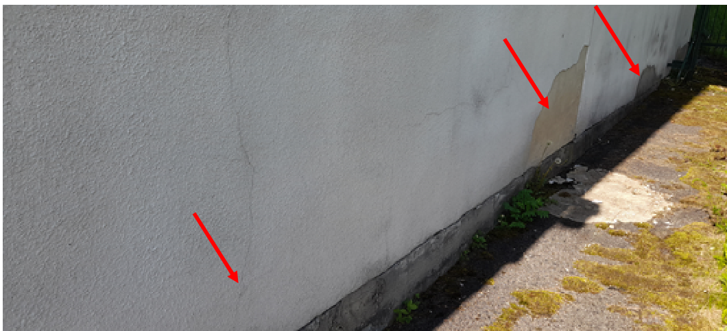
Obr. 89 Opadaná omítka panelů, částečně vyspravená, vlásenkové praskliny omítky panelů
