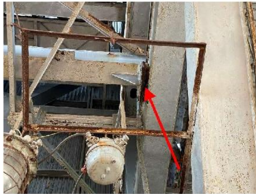
Vada č. 6 – plátová koroze příčniku, osy A, C v úrovni cca 7,25 m
