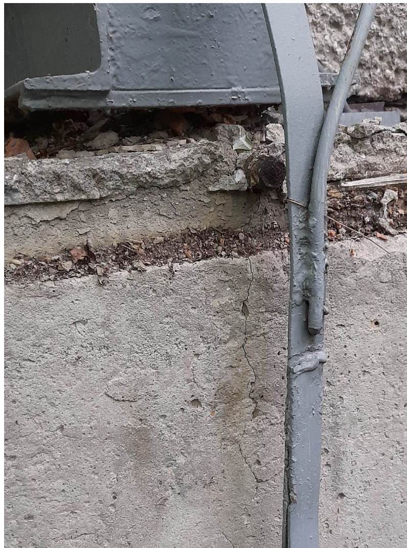
Obr. 24 Trhlina v základovém pasu
