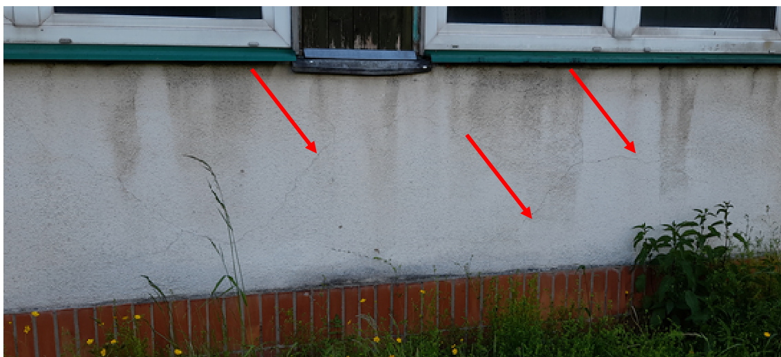
Obr. 160 Praskliny v panelu nad úrovní základové konstrukce
