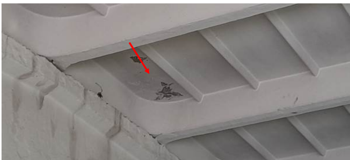
Obr. 62 Lokální vlhkostní poruchy v místě stropní konstrukce hlavního objektu
